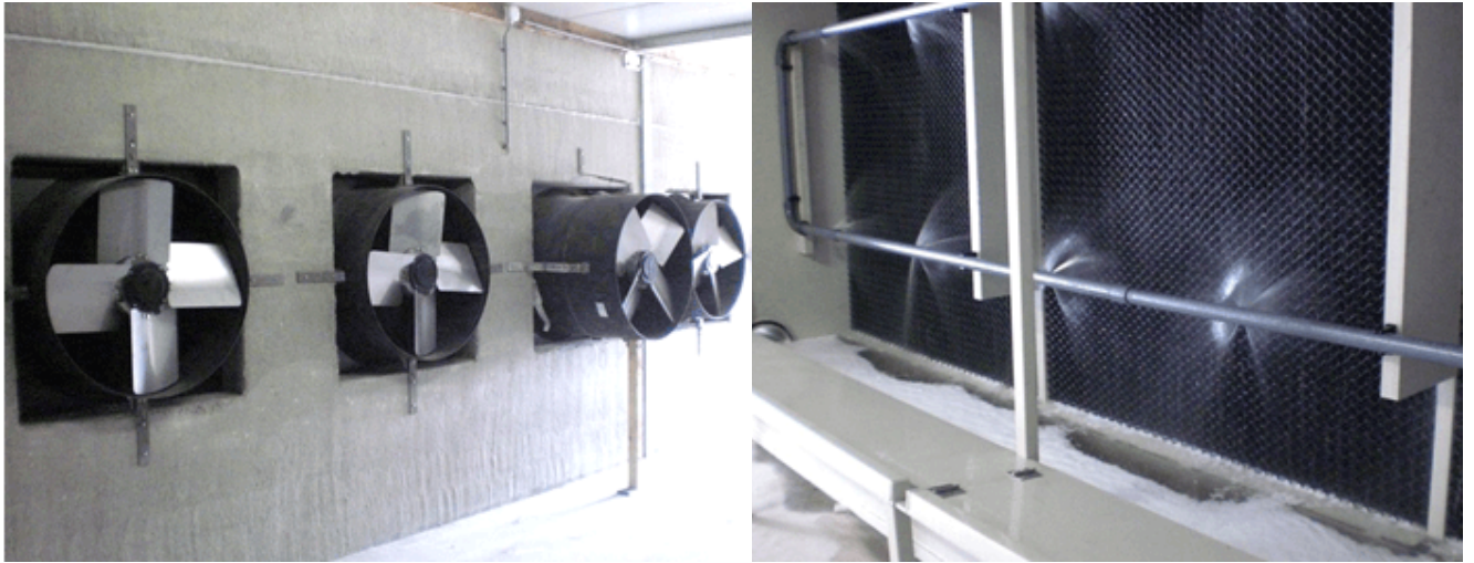
Figuur 16 Chemisch luchtwassersysteem in een vleeskuikenstal (Bron: Boerderij)
