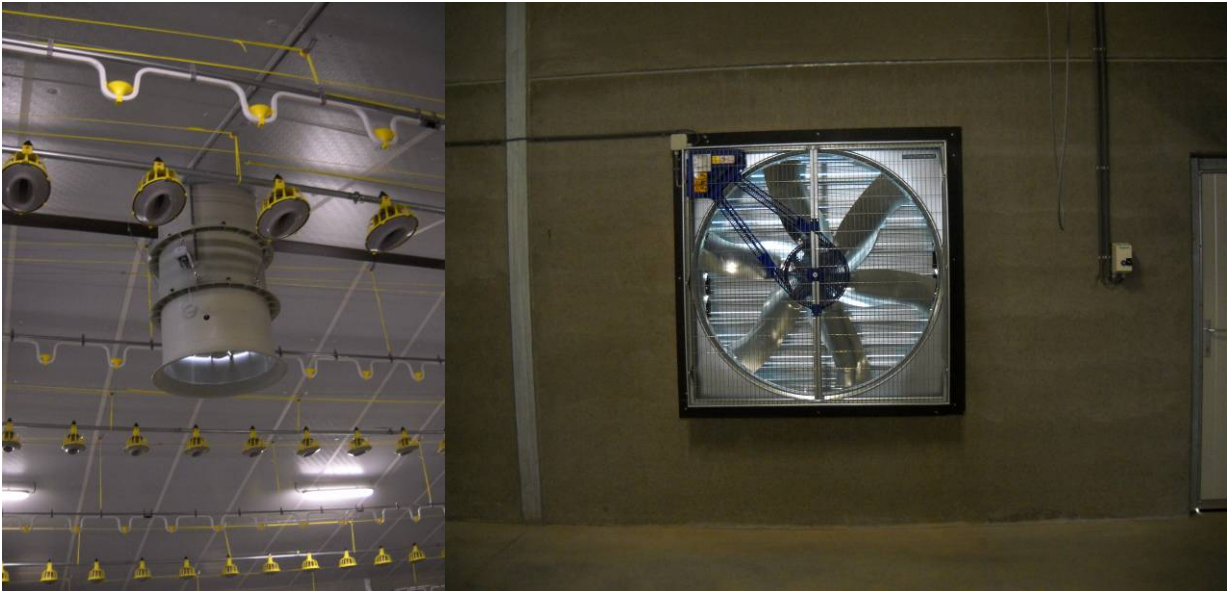
Figuur 14 Dakventilator en lengteventilator in dezelfde stal
