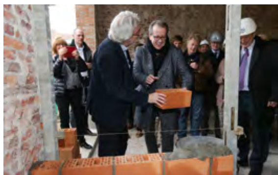
Steenlegging in Lier, 23 oktober. Gedeputeerde Peter Bellens (links), schepen van wonen Walter Grootaers en voorzitter Jan Hauwaert van SHM Lierse Maatschappij voor Huisvesting (rechts) leggen de eerste steen van het project Gendarmerie.
