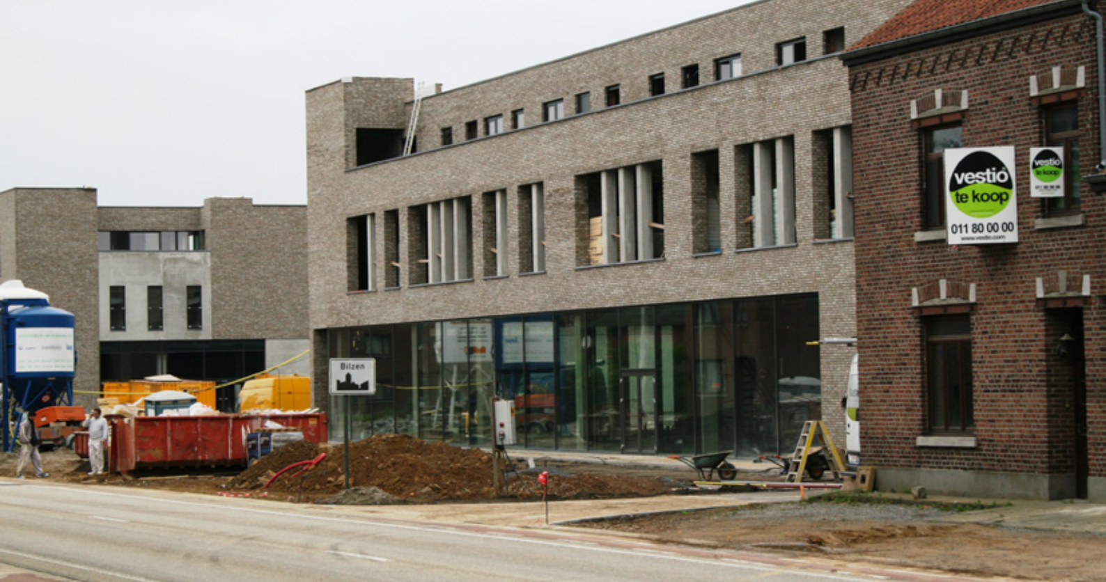
Het project Tongersestraat van Kolmont Woonprojecten in Bilzen: op het gelijkvloers bevinden zich winkels, op de eerste verdieping 11 sociale appartementen en op de tweede verdieping privé-appartementen.
