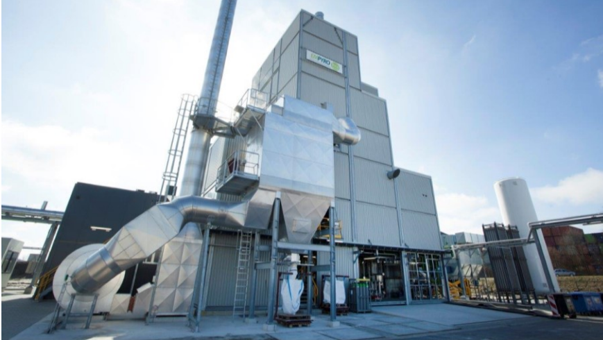
BTG Empyro pyrolyse installatie in Hengelo, Nederland. Bron: BTG
