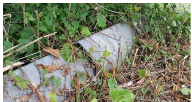
▼ Geleidingswand met spleten en overgroeid met vegetatie (N758 Elderenstraat Tongeren) Foto © Griet Nijs
