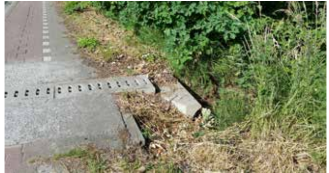
▲ Geleiding naar de tunnelingang ontbreekt (Bogaardenstraat Oud-Heverlee) Foto © Griet Nijs
