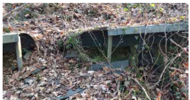
► Beschadigde geleidingswand (N223 Aarschotsesteenweg Tielt-Winge) Foto © Ilf Jacobs
