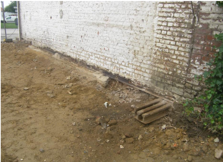
Figuur 22: Zicht naar het oosten op de noordgevel van Sint-Medardusplein 12, langs de toenmalige toegangsweg tot de werf. Bij de wederopbouw heeft men spoorstaven in de funderingen verwerkt.
