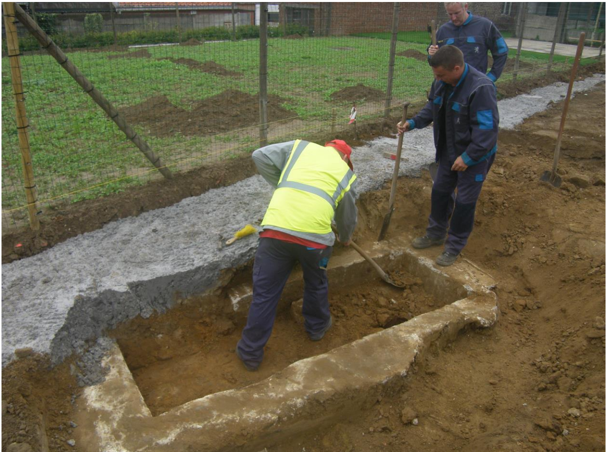
Figuur 4: Vindplaats A tijdens het vrijleggen. Enkel de rand van de toegangstrap was zichtbaar bij aanvang van het terreinonderzoek. De toegangstrap die volgestort was met grond, werd manueel uitgegraven. De vondst van de muurtjes, die onder het beton doorlopen, werd niet gemeld.
