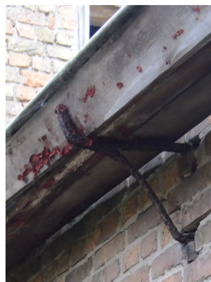
Fig. 43: metalen 'modillon' (of gootconsole) ter ondersteuning van de bakgoot op de hoeve De Roode Poort in Westende (Onroerend Erfgoed, F. Becuwe).
