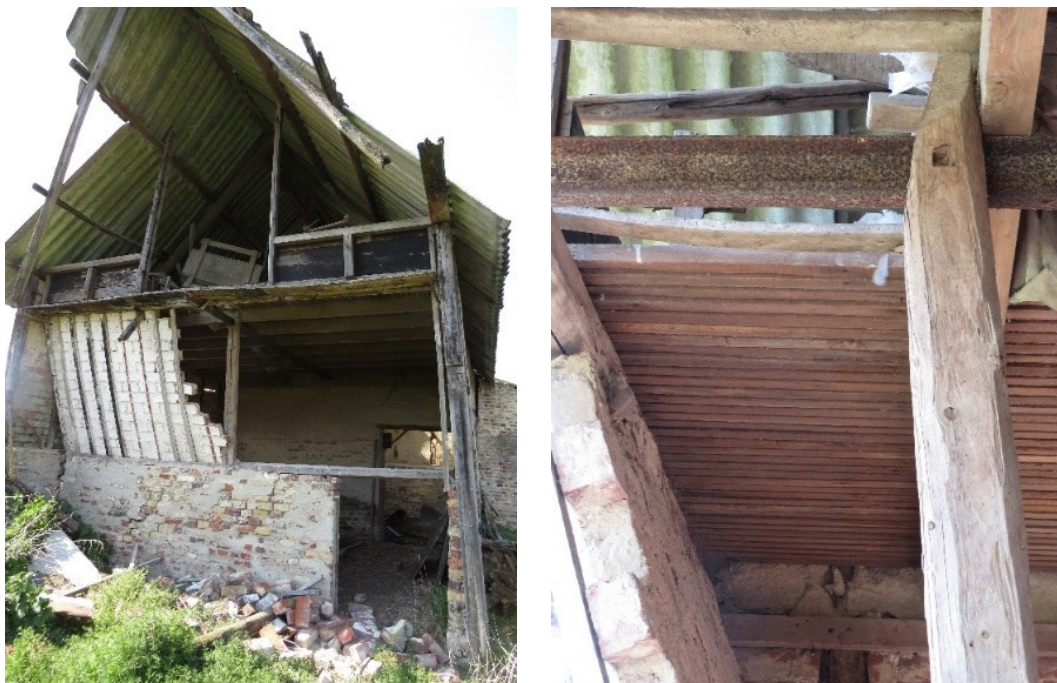
Fig. 158: de hopast op de hoeve in de Blérotstraat 4, met restant van de tremelvormige 'hel' en de houten eestvloer (Onroerend Erfgoed, F. Becuwe).
