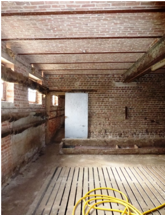
Fig. 82: zoldering van troggewelven in de koestal op de hoeve Foch Farm* in Boezinge (Onroerend Erfgoed, V. Debonne).
