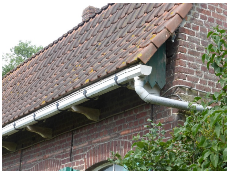
Fig. 42: mansardedak met overstek op houten gootklossen bij de wederopbouwhoeve van 1922 in Millekruisestraat 10 in Loker (Onroerend Erfgoed, P. Vanneste).
