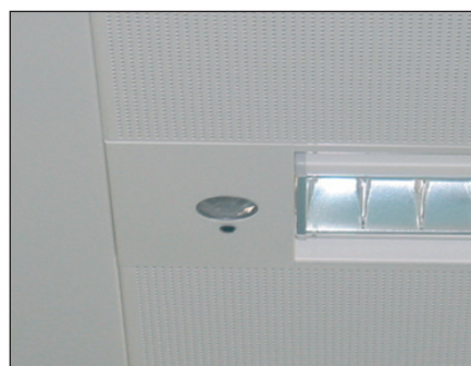
Op de lamp bevestigde daglichtsensor
