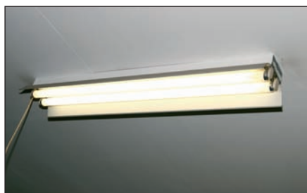
Naakte TL-buizen, armaturen waarbij men rechtstreeks zicht heeft op de lamp
