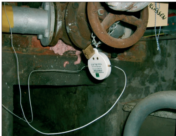
Figuur 17: temperatuurloggers geïnstalleerd in de stookplaats van een school
