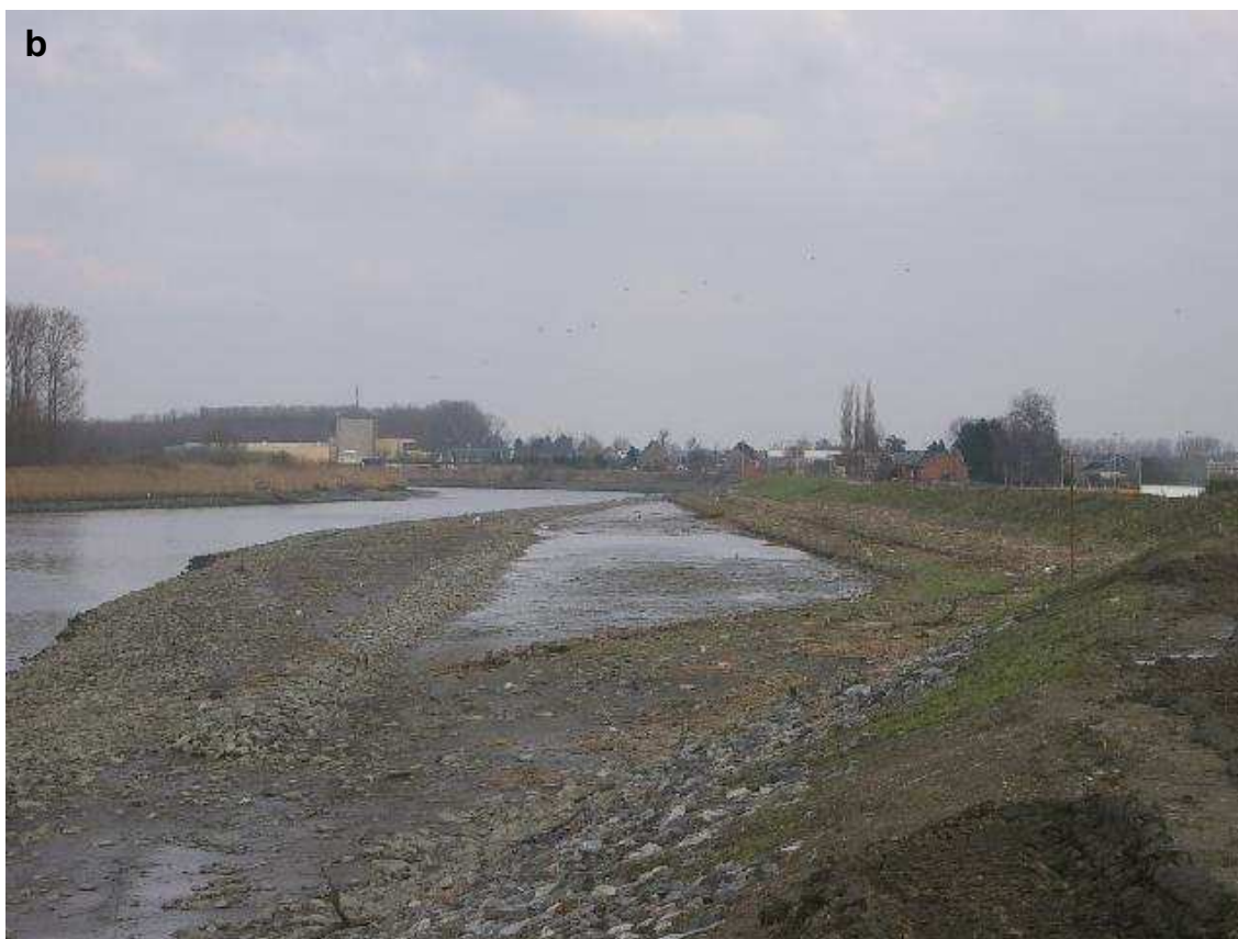
Figuur 4.8: Paddebeek: a. tijdens de werkzaamheden (juli 2003) en b. na de herinrichting (maart 2004).
