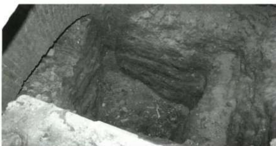
d. Schoolvoorbeeld van een stabiliteitsprobleem door differentiële zetting met afschuivingsverschijnselen (zie de schuin-oplopende barsten) (foto W. Slock)
