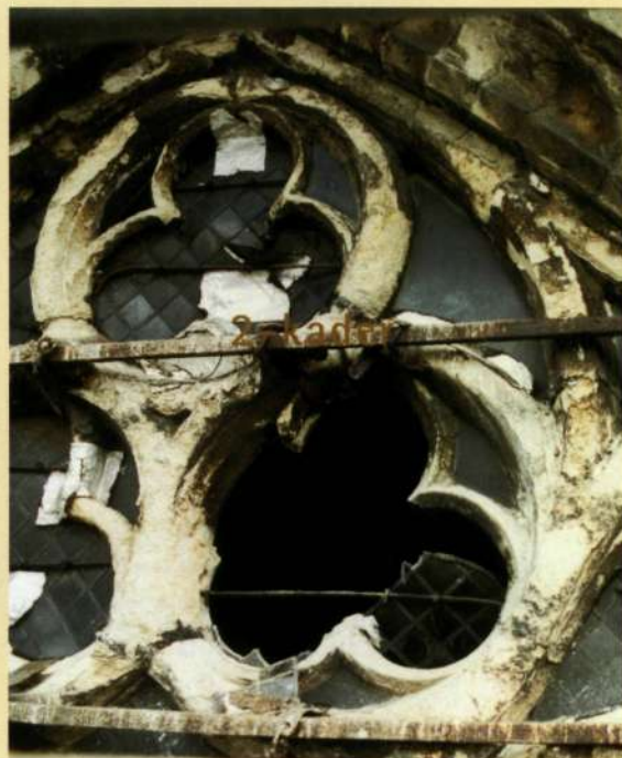
▼ Dramatische toestand van de venstermonelen en van het glas (foto W. Slock)
