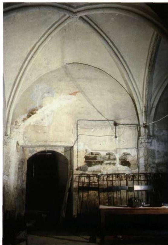
▼ Linkerhelft van de noordmuur met ingang deur, vóór de behandeling (foto L. Van Dijck)
