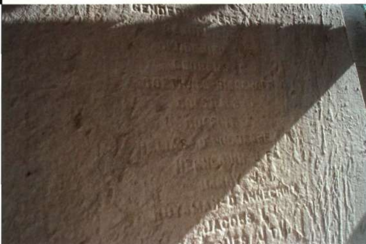
▲ Detail van een marmeren bord aan westzijde, vóór vervanging (foto Regie der Gebouwen, 2001)
