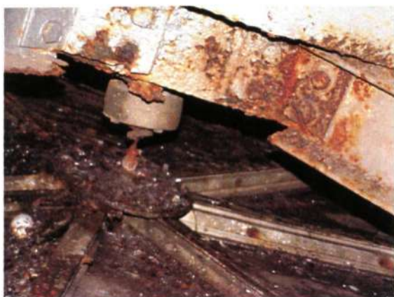
► Corrosie van de structuur (foto Seco)
