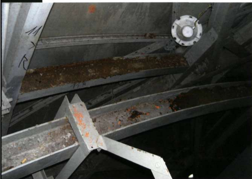
▲ Corrosie van de structuur, M-bol (foto Origin)
