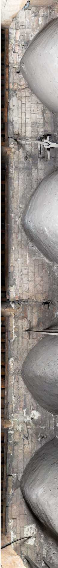
FIG. 2.20 Tongeren: O.L.V.-basiliek: metselwerk van het koor boven de gewelven (noordzijde), met bouwnaad tussen de tweede en de derde westelijke travee (bewerkte compositiefoto, zie voor een onbewerkt beeld: fig. 2.21bis) (links).
