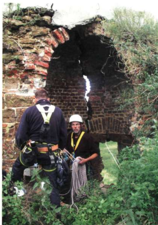
Inspectie van Monumentenwacht (foto Monumentenwacht Vlaams- Brabant)
