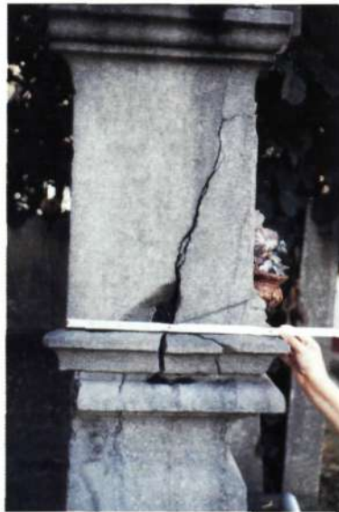
De gebarsten nis (eigen foto)
