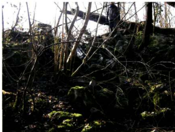
▼ De cascade, zwaar beschadigd door een vallende boom (foto R. Deneef, 2006)
