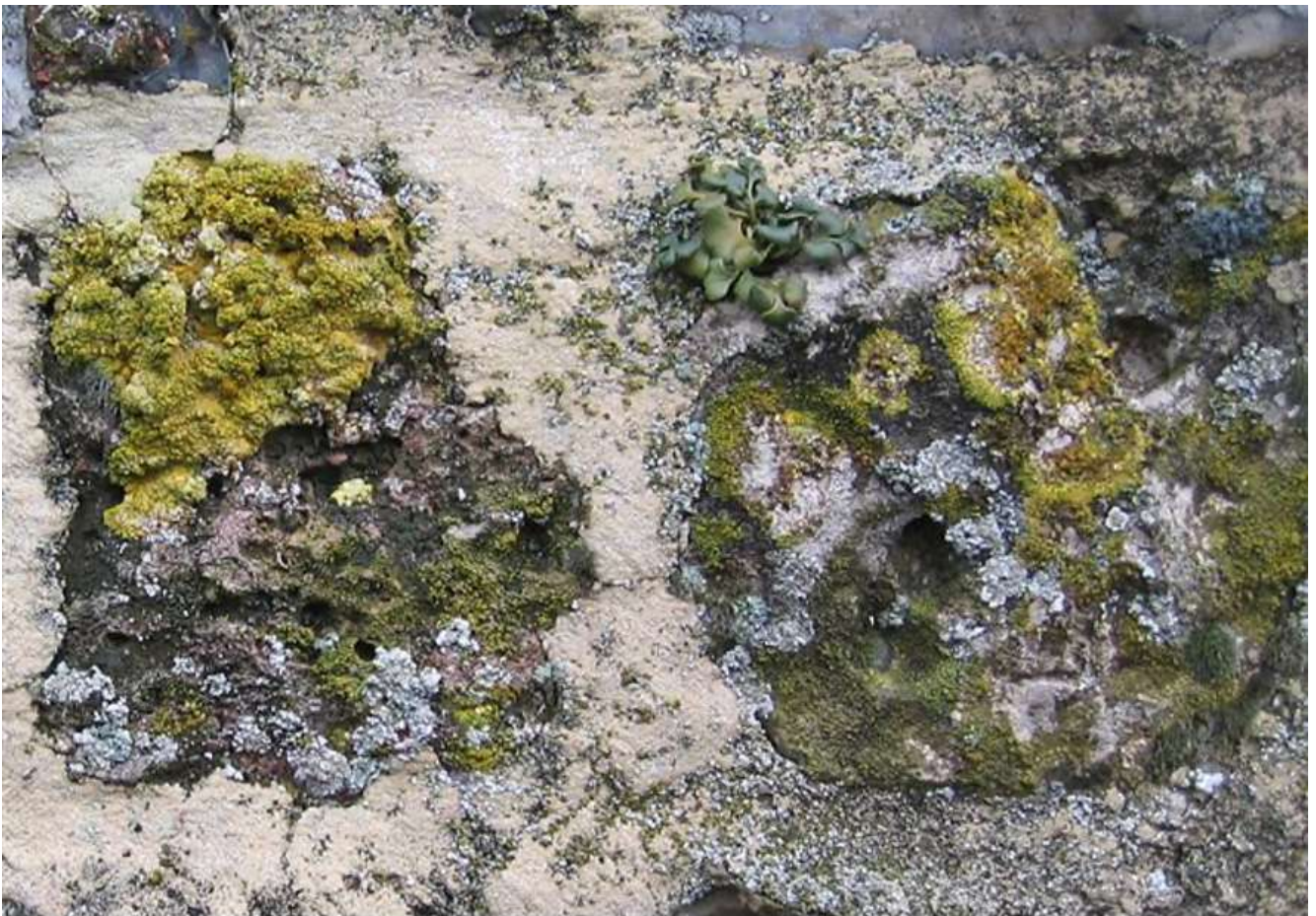
FIG. 30. Kolonisatie door korstmossen, mossen en hogere planten op blokjes kalktuf in een historisch gebouw
