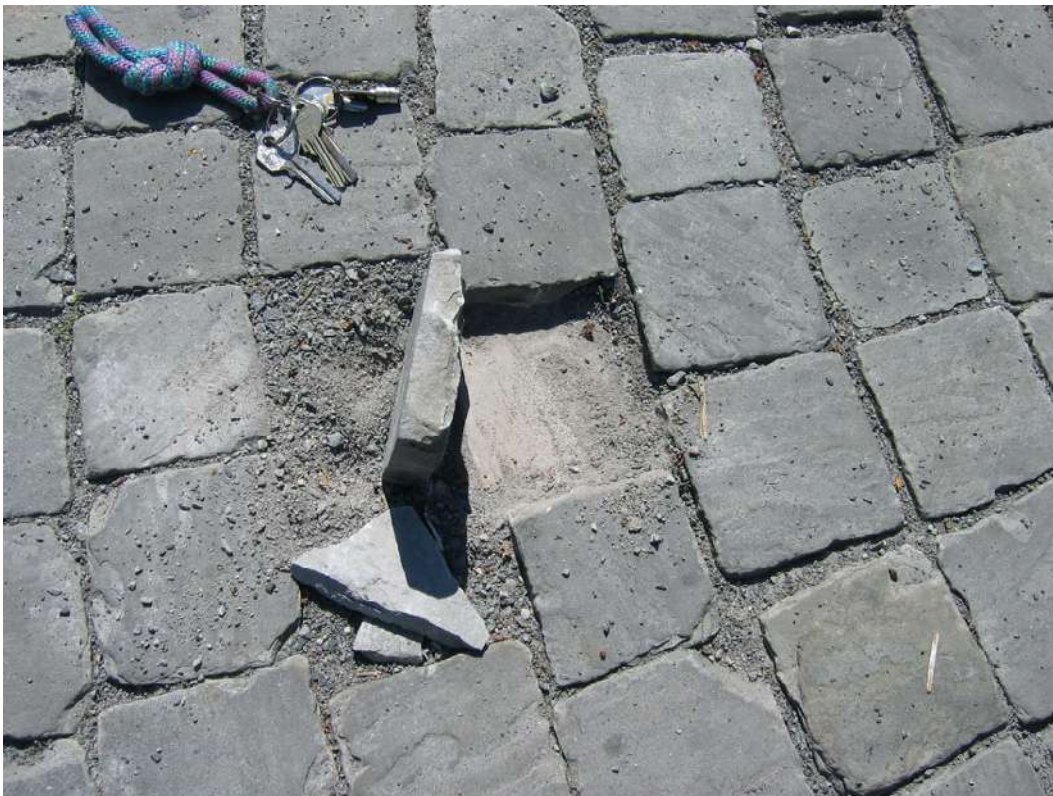
FIG. 100. Schade aan platines (kasseien met een vlakke bovenkant) gemaakt van Indische zandsteen.
