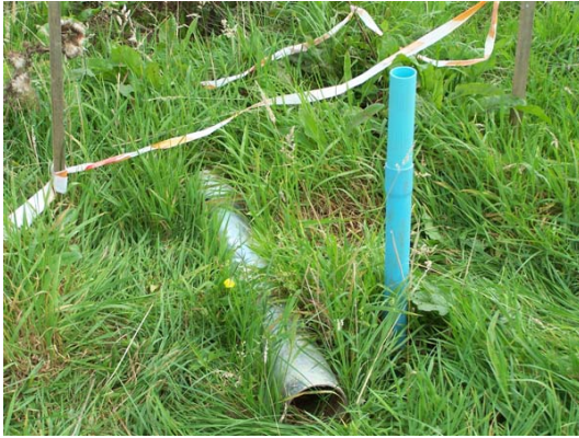
Situatie van de schade aan piëzometer LMNP003X, vastgesteld op 27 augustus 2007
