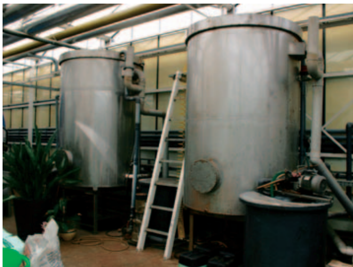
Een ontijzeringsinstallatie verbetert de kwaliteit van sterk ijzerhoudend ondiep grondwater.
