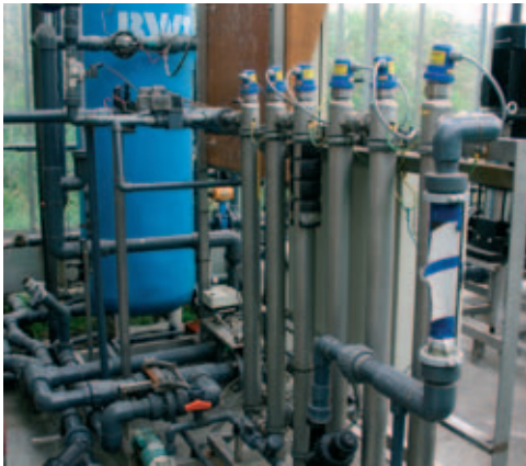
Bij lagedruk UV-ontsmettingsinstallaties kan het aantal UV-lampen aangepast worden in functie van de bedrijfs-grootte.
