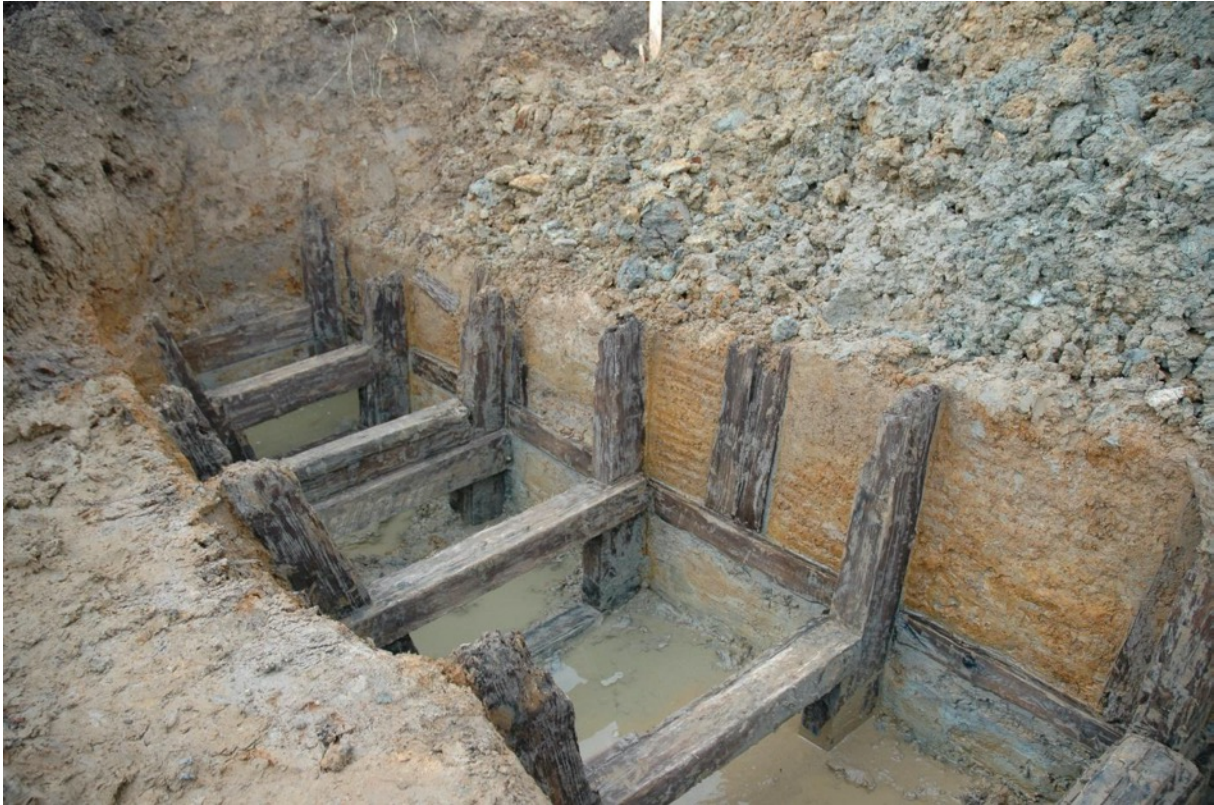
Fig. 8-14 De geconsolideerde fase van Helm Trench (LPG_ID62). De achterste A-frames zijn duidelijk aangepast met extra dwarsliggers. (© Onroerend Erfgoed)
