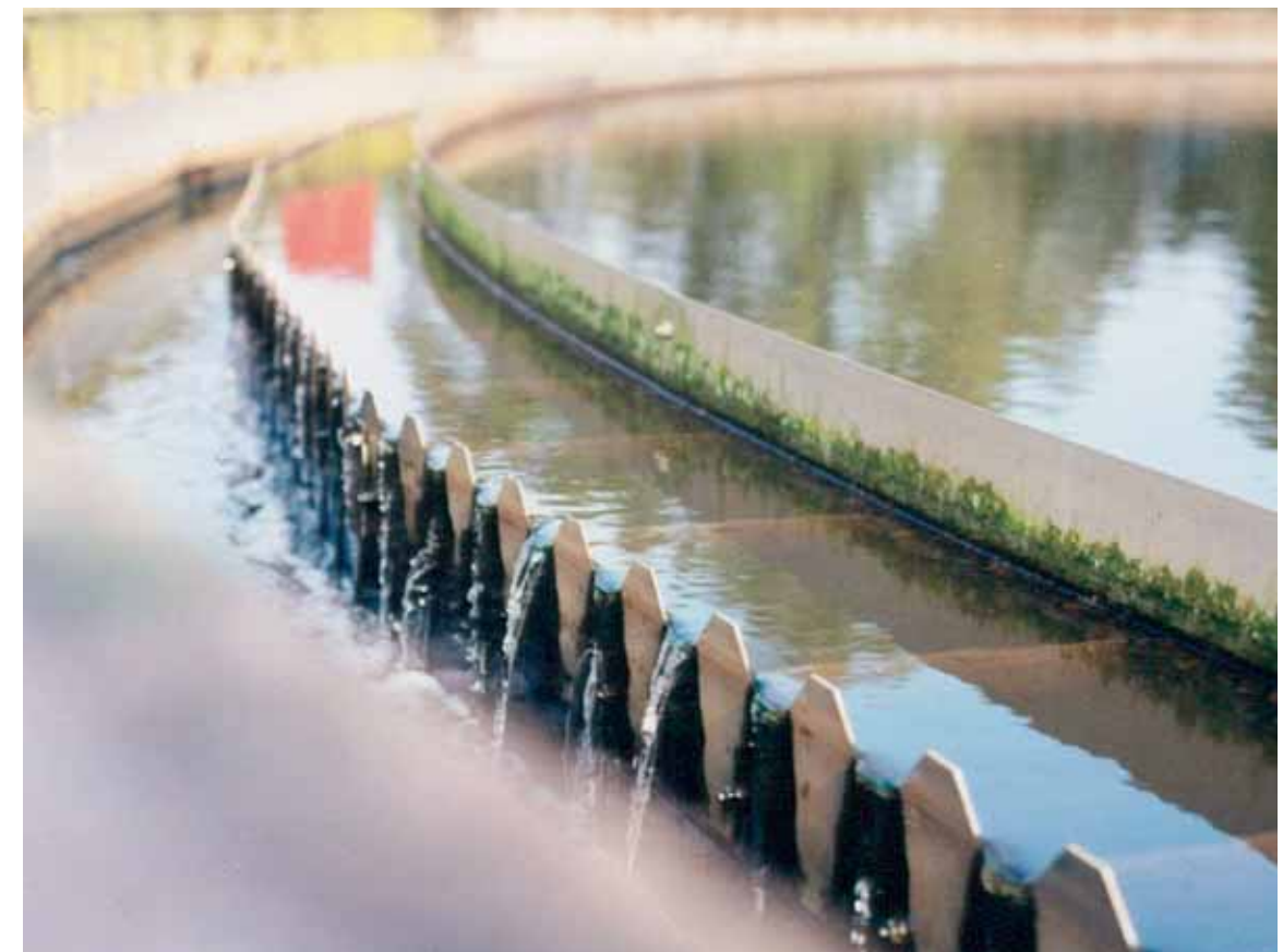
Close-up van een bezinktank van een rioolwaterzuiveringsinstallatie. Het vuil vlokt samen op de bodem in het centrum van de tank (rechts buiten beeld); geklaard water stroomt langs de randen over en verlaat de tank naar de volgende zuiveringsfase.
