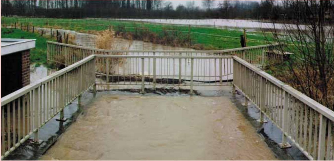
Overstromingen in het natuurgebied Honegem aan de stuw aan de Ledebaan te Erpe-Mere. (Foto IMDC, 31 december 2002)
