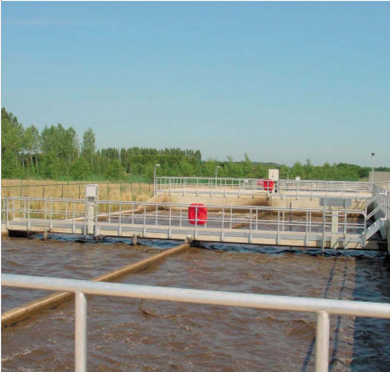
Rioolwaterzuiveringsinstallatie te Halen.
