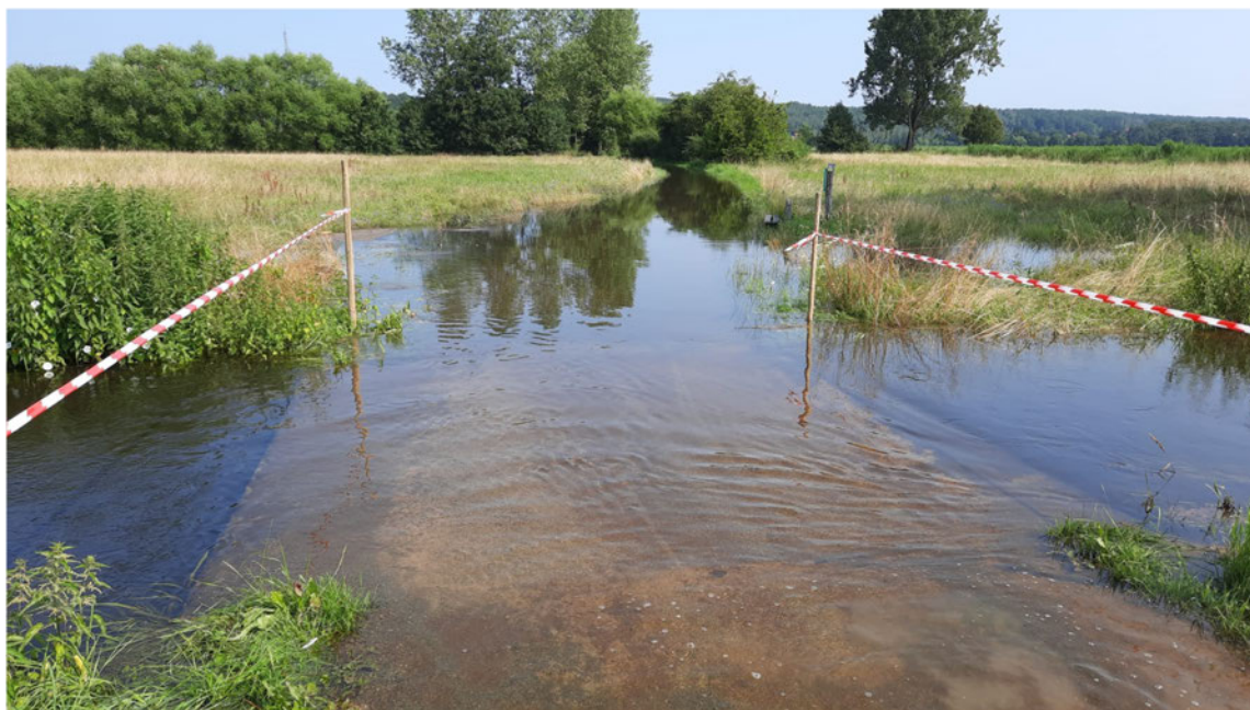
Figuur 42 – Overstroming van de vallei van de Weerdelaak ter hoogte van de duiker onder de Mottestraat te Aarschot (20/07/2021) (bron: stad Aarschot).
