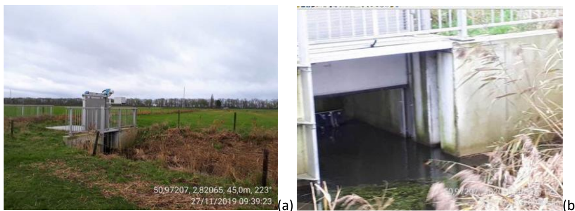
Figuur 47 Foto's van de “hydraulische isolatieschuif” en terugslagkelp in de Engelendelft. De schuif kan het gebied ten Zuidoosten van de constructie isoleren van het bemalingsgebied van het gemaal van Woumen (bron: Maarten Goegebeur, VMM). (a) foto van het geheel. (b) detailfoto van een openstaande schuif met daarachter de (gesloten) passieve terugslagklep.
