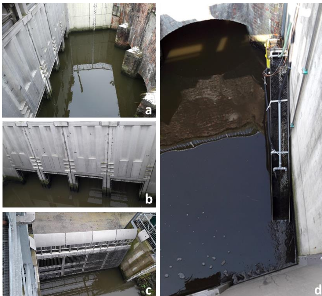
Figuur 6 Het terugslagkleppencomplex aan het Caemerlinckxgeleed met een beperkt niet-overdekt gedeelte tussen de terugslagkleppen (b) en een duiker (a, rechts in beeld) waar de glasaalgoot langs de rechterdamwand werd geplaatst (d). Het krooshekken bevindt zich aan de stroomopwaartse zijde van het complex (c).
