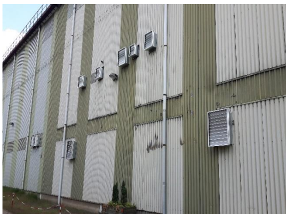
Figuur 33: Ventilatoren werden uitgerust met lamellen.
