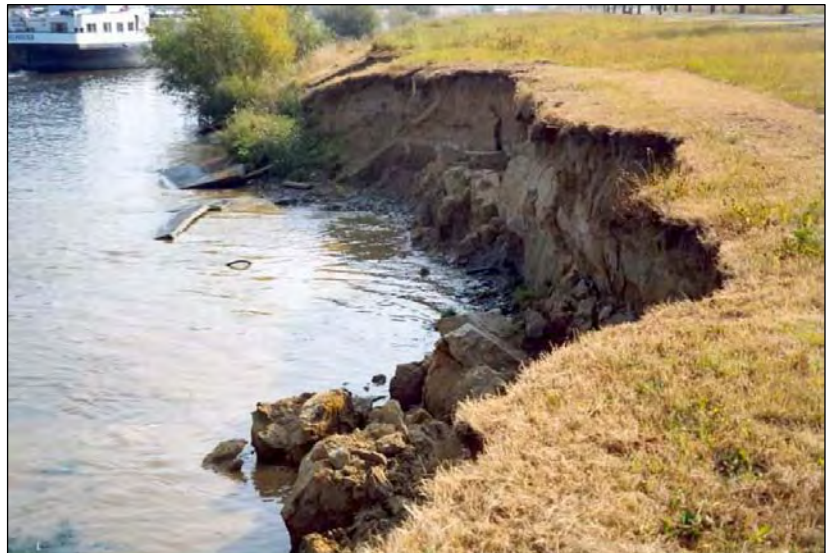
Foto 2: De grote debieten op de Leie spoelden heel wat betonnen damplanken weg. De rivier is haar keurslijf kwijt, de dynamiek wordt terug zichtbaar onder de vorm van grote oeverafkalvingen die op bepaalde plaatsen de jaagpaden ondermijnen (vrije dynamiek is hier niet meer mogelijk).
