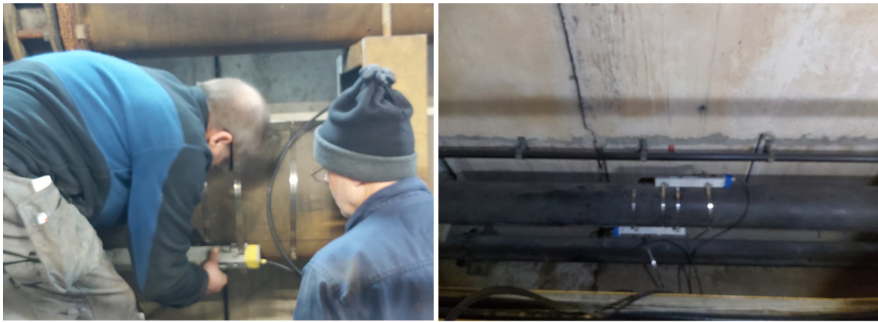
Figuur 3 – Krohne ultrasone debietmeter geklemd op de buizen waarin het water vanuit de pompkelders wordt getransporteerd
