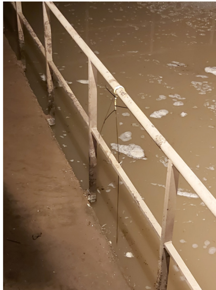
Figuur 4 – Divers opgehangen aan een inox kabel in de zuidelijke pompput. De divers hangen tot net boven de bodem van de kelder
