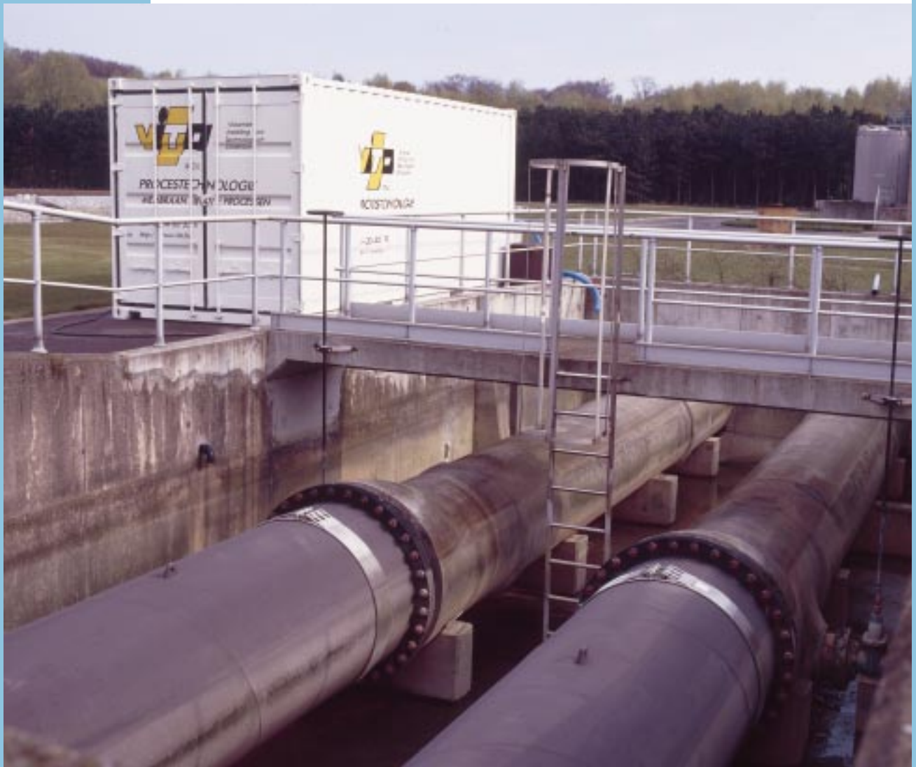
Mobiele filtratiekringloop voor het uitvoeren van tests op industriële sites
