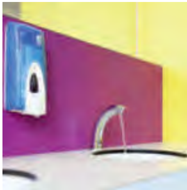
Kraan met automatische bediening en zeepdispenser nabij.
