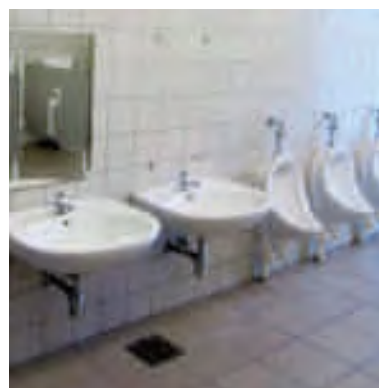
In het kleutersanitair worden wastafels en urinoirs lager voorzien.
