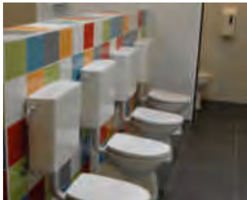
Een combinatie van open toiletjes en één afgesloten toilet voor wie meer privacy wil.
