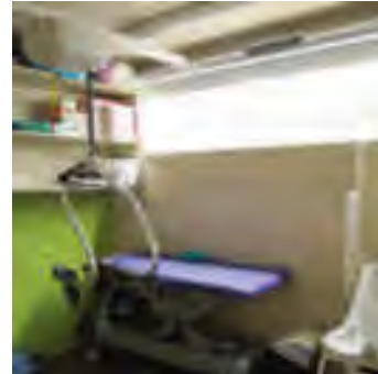
Een plafondlift met een traverse systeem.
