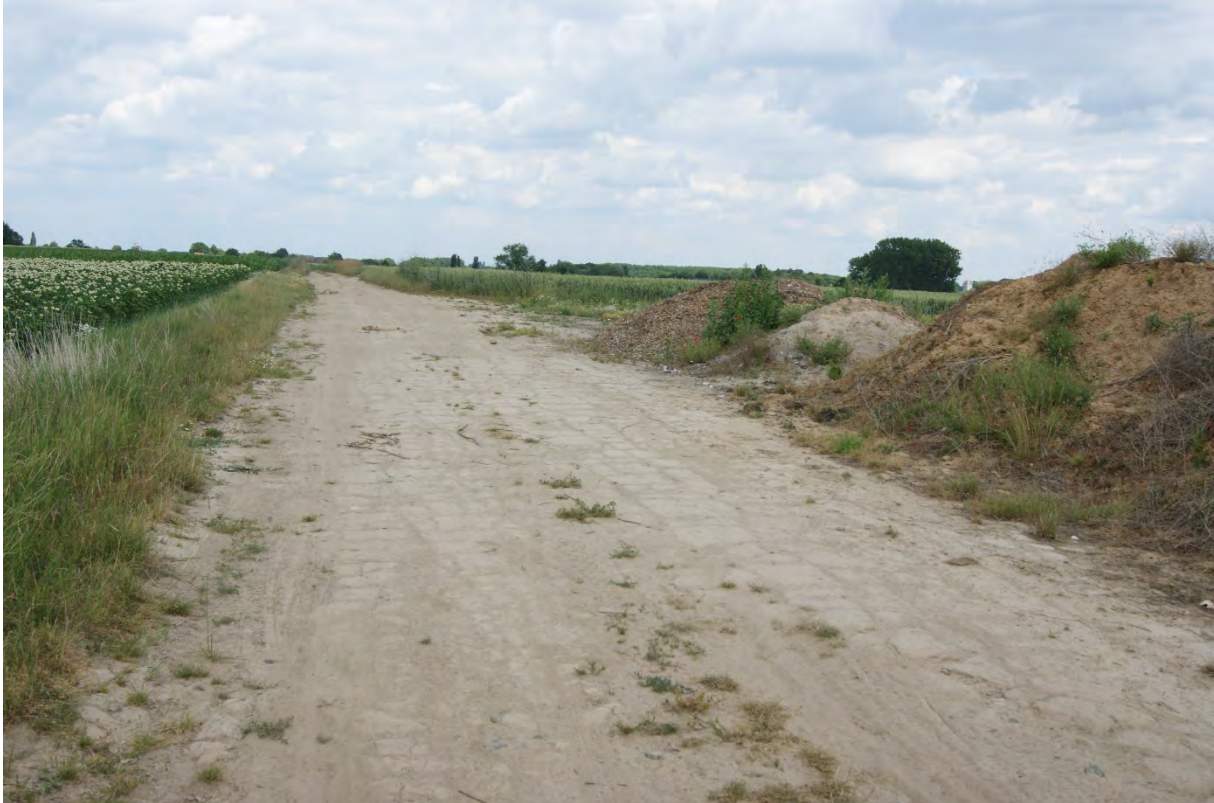
Foto 74 – relict 4, zicht op de resten van de betonverharding thv de Weg van Croix-Gettoux voor de Ruilverkavelingswerken
