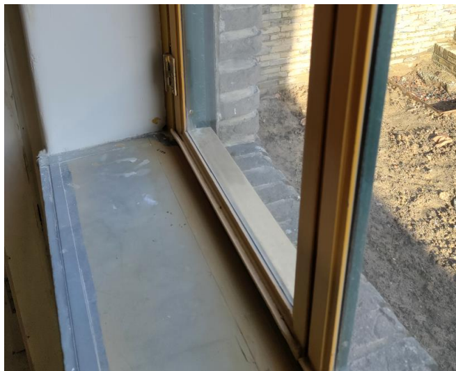
Figuur 69. Detail van condensgootje onderaan een raam dat hersteld en opnieuw geplaatst is. Centraal in de opengaande vleugel is een afvoergaatje voorzien. (Foto: WTCB)
