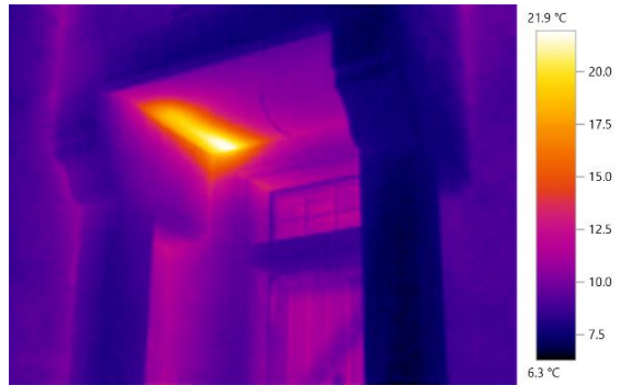
Figuur 14. Detail van de onderkant van de erker in 2021: de warme plek komt overeen met een plaats waar een niet-geïsoleerde verwarmingsleiding ligt. (©WTCB)
