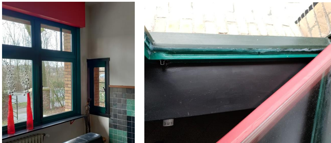
Figuur 142. Groot en klein raam vooraan in de living. Het glas van het grote raam is vervangen door dun dubbel glas. Er is een tocht dichting voorzien in siliconen, aangezien het niet mogelijk was om een tochtstrip in te brengen. (Foto's: WTCB)
