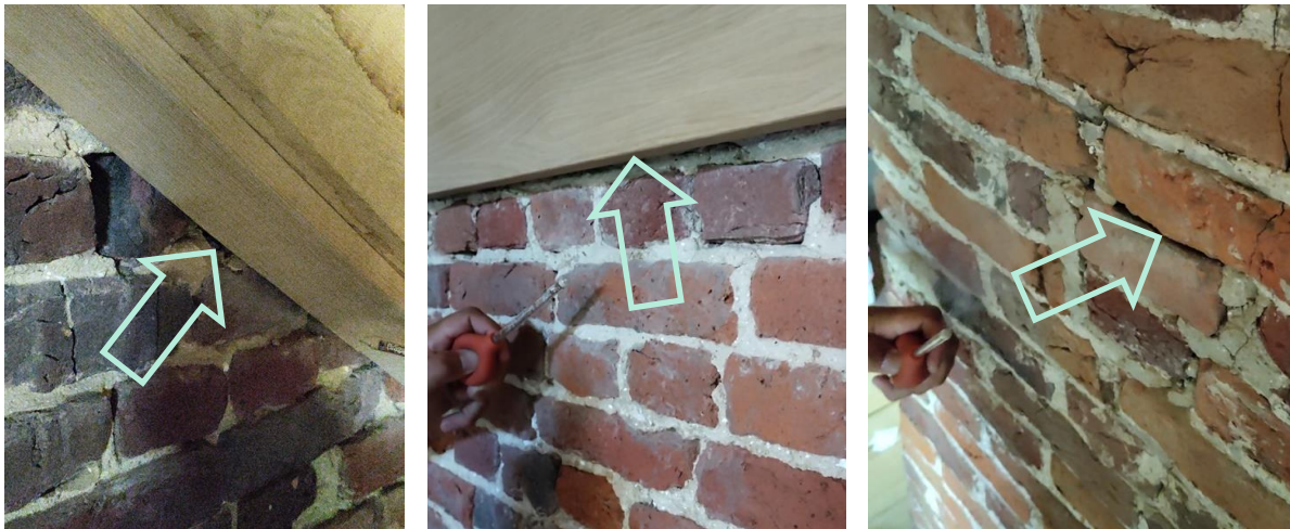
Figuur 105. Drie typerende plaatsen van luchtlekken in de zolderverdieping: de aansluiting met de zijmuren, de aansluiting met de voor- en achtergevel en openingen in het metselwerk. (Foto's: WTCB)
