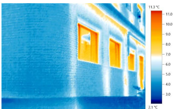
Figuur 75. Gevel van de bibliotheek: koudebruggen ter hoogte van de leidingenkokers en betonnen lateien boven de ramen (30-01-2018) (©WTCB)
