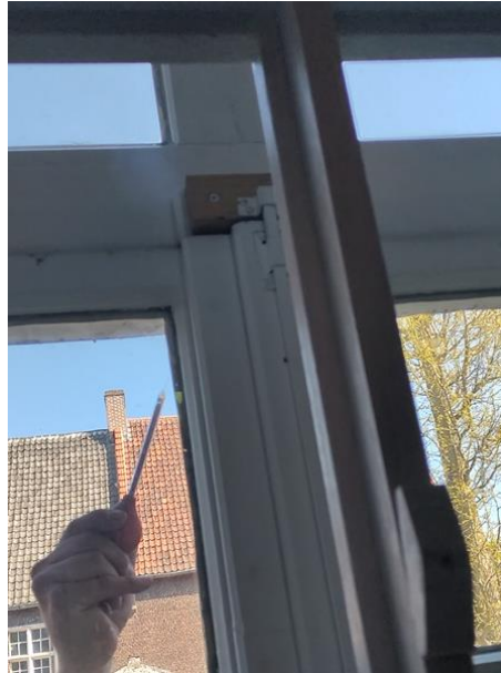
Figuur 178. Rook die door een slechte aansluiting van de opengaande raamvleugels van buiten naar binnen stroomt. (Foto: WTCB)
