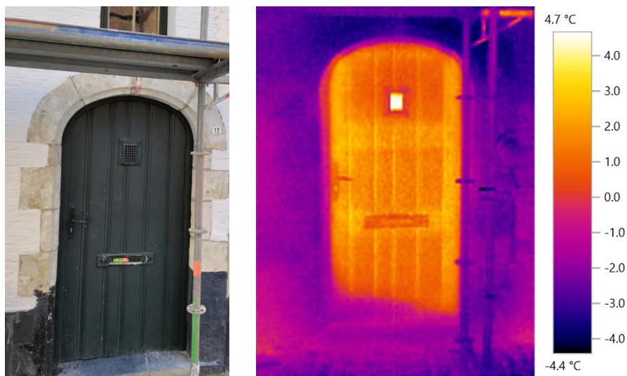
Figuur 39. Bij de voordeur tekenen de achterliggende stijlen zich af. Door het breken en verzakken van het linkerdeel van de dorpel is een spleet ontstaan. Blijkbaar trekt langs die spleet koude lucht naar binnen, zodat de linkeronderhoek van de deur een stuk kouder is dan de rest. Het kijkgaatje boven in de deur is dan weer een warm element. (©WTCB)
