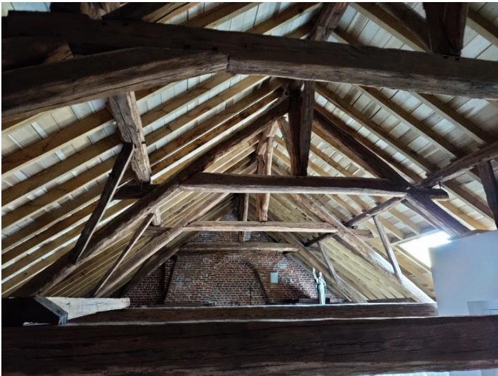
Figuur 90. Open originele dakstructuur waar bovenop een nieuw sarkingdak is aangebracht. (Foto: WTCB)
