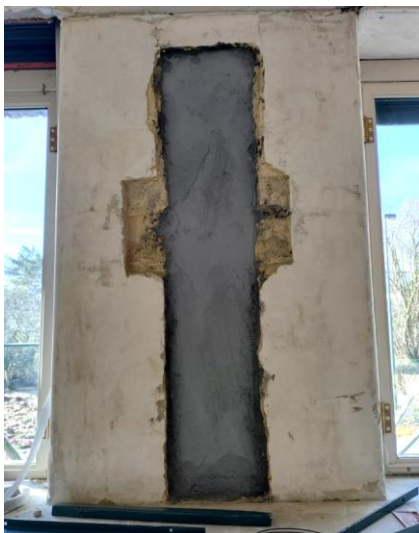
Figuur 68. Vrijgemaakte leidingkoker in bibliotheek die aan de binnenkant geïsoleerd wordt. (Foto: WTCB)
