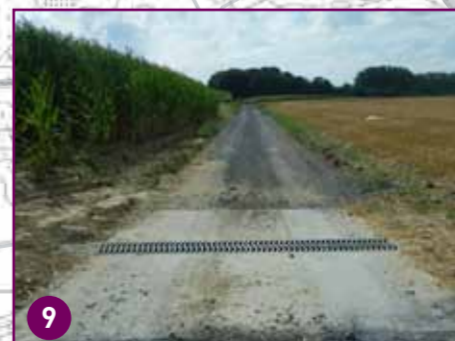
9 Heraanleg weg: opvangroosters voor afstromend water (juli 2012)
