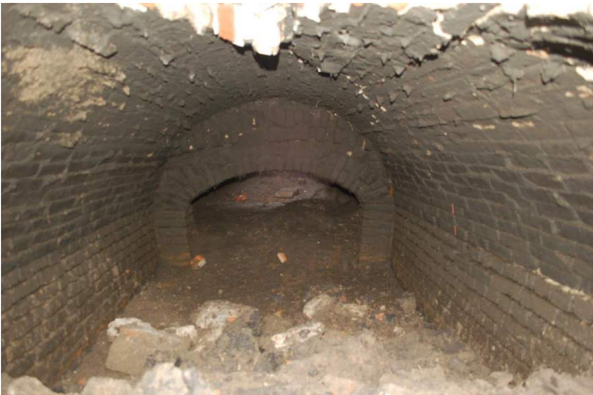
Figuur 15: Zicht vanuit het noorden op de binnenzijde van het intacte zuidelijke deel van de ondergrondse structuur. Achter een bakstenen boog met steunberen is geen muur zichtbaar maar lichtinval vanuit de bewaarde toegangspuit. Op de vloer ligt een laag slib, die geleidelijk oploopt naar het zuiden toe (achteraan op de foto).
