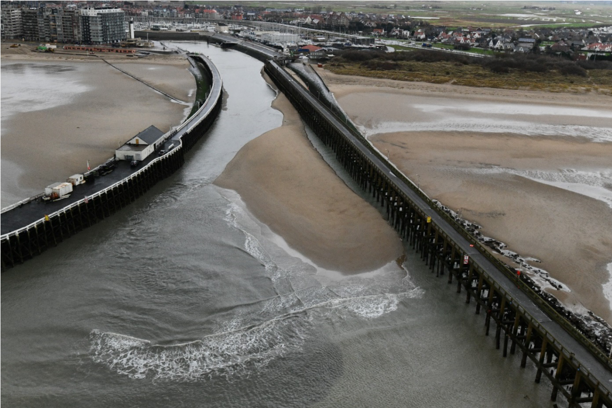
Figure 146 – Areal photograph of the sedimentation in the channel after storm Ciara (© Koninklijk Belgisch Instituut voor Natuurwetenschappen (KBIN))
