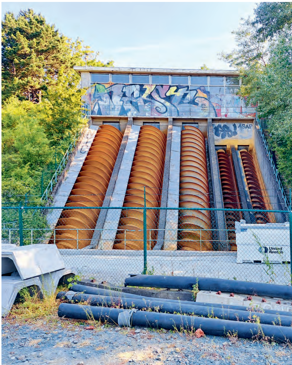
Het pompgemaal aan de Desguinlei zorgt ervoor dat de Antwerpse Ring, die een stuk dieper ligt dan de omgeving, droog blijft. © Stad Antwerpen
