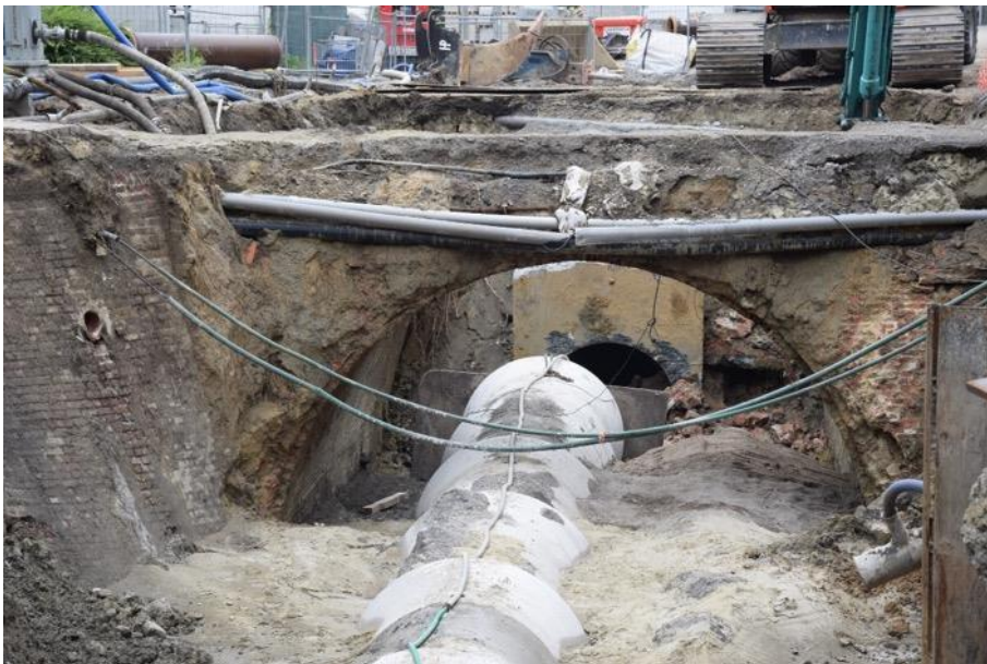
Figuur 4: Beeld van de baksteen massieven die vrijkwamen bij de rioleringswerken (© agentschap Onroerend Erfgoed).
