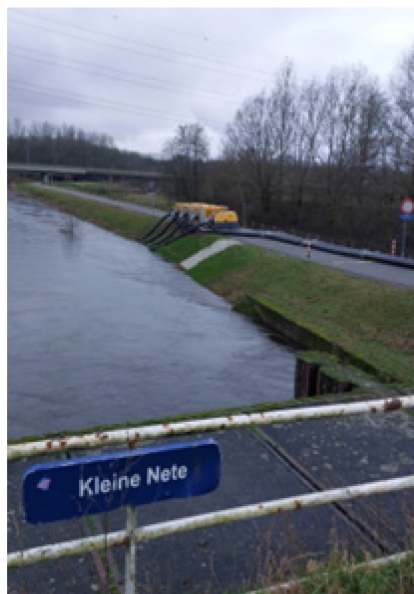
Figuur 68: Pompen van Kleine Nete naar Albertkanaal, geplaatst op vraag van de burgemeester van Grobbendonk
