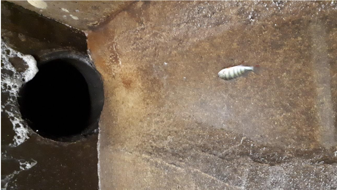
Foto 18: Baars die op het drogen ligt door mogelijks een te kleine hellingshoek van het beton in de pompkelder.
