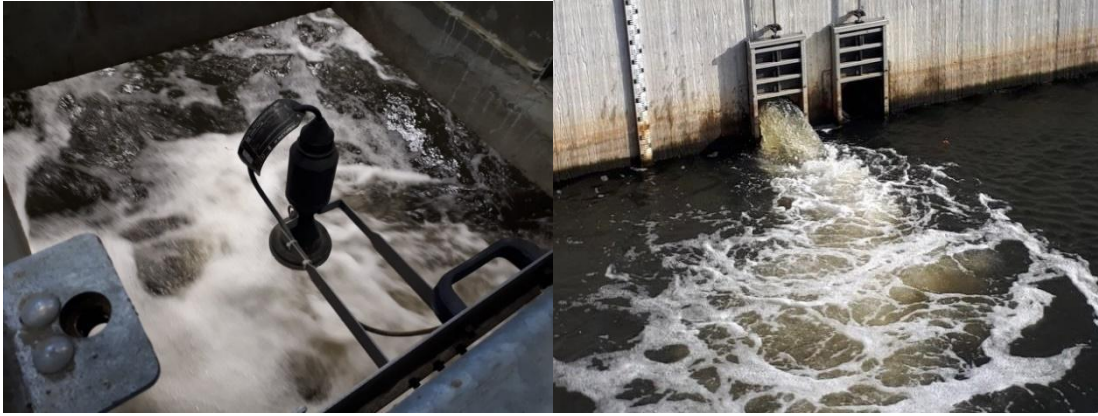
Foto 5: Een van de twee verzamelruimtes onder het PPGS tijdens vijzelwerking (links). Twee gravitaire uitstroomopeningen van beide verzamelruimtes die alternerend water lozen in het Groot Schijn stroomopwaarts van het PGGG (rechts).
