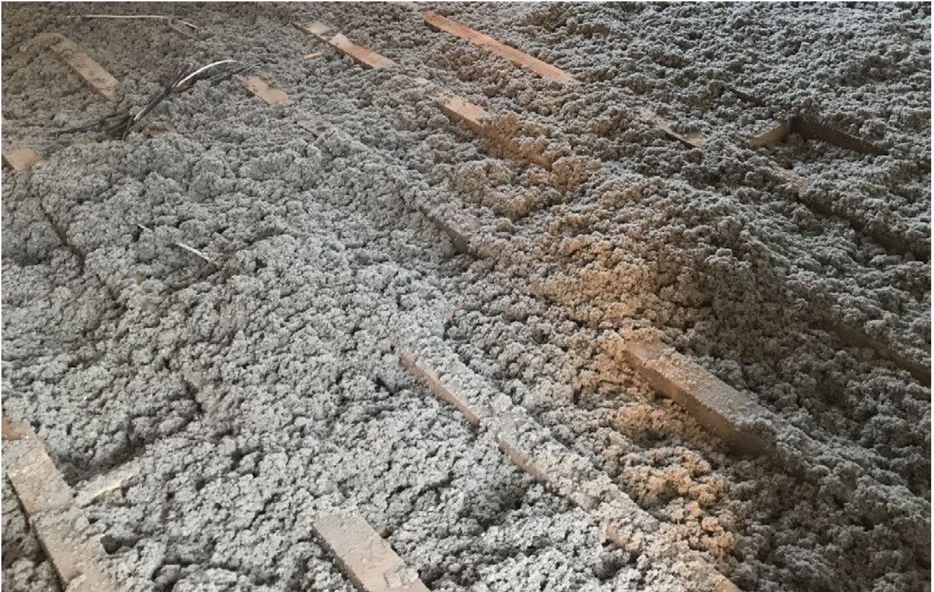
Ingeblazen cellulose in een houten vloer ter verbetering van het thermisch en akoestisch comfort
