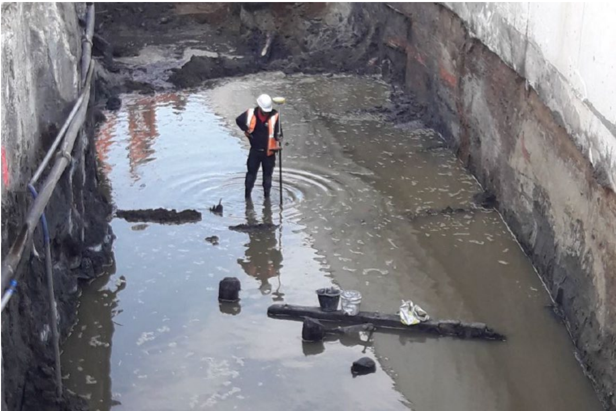
Fig. 5.35: Antwerpen - Scheldekaaien: zone Loodswezen, werkput 1E, overzicht vlak 5 met houten palen gedeeltelijk zichtbaar (© BAAC Vlaanderen bvba).
