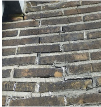
Scheurvorming in het metselwerk ERFGOED & VISIE BVBA
