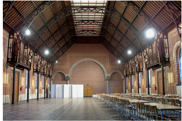
Het dak werd aan de buitenzijde geïsoleerd door middel van het sarking-principe. Het niet originele verlaagde geïsoleerde plafond dat de dakstructuur aan het oog onttrok, kon verwijderd worden en zo werden ook de daklichten opnieuw functioneel. Merksplas, kapel Kolonie.
