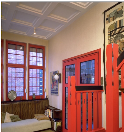
Plafond, schrijnwerk en vast meubilair maken binnen-isolatie niet evident in deze modernistische woning
