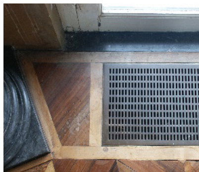
De aansluiting van de parketvloer op de verwarmingsrooster, zuilbasis en deurdorpel maakt een opdikking van de vloer onmogelijk.
