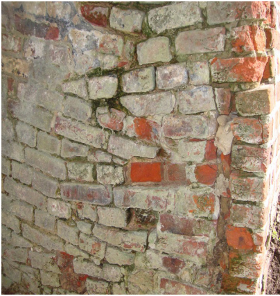
Verzakking in het metselwerk. ONROEREND ERFGOED
