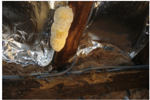
Deze foto toont een aantasting door houtzwam als gevolg van een ernstig lek. In het volledige gebouw werd de binnenzijde geïsoleerd en afgewerkt met gipsplaten vooraleer het lekke dak te herstellen.
