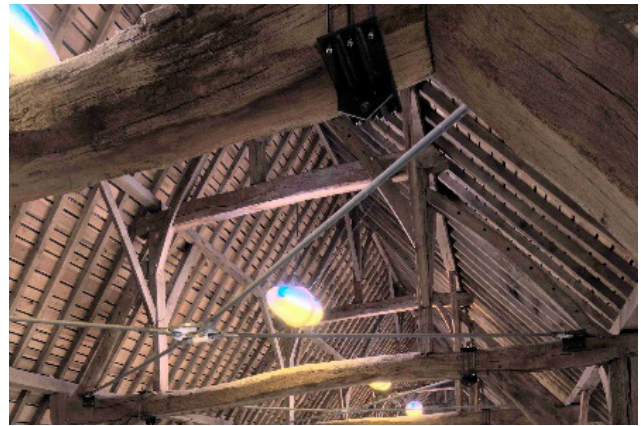
De Tiendenschuur na restauratie. De constructie werd verstevigd en verstijfd met nieuwe stalen elementen die subtiel tussen de bestaande constructie werden aangebracht. Herkenrode, abdij site.
