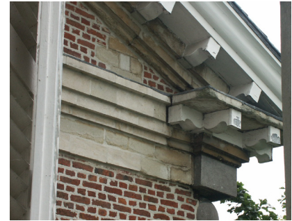
Het geprofileerde lijstwerk maakt een buitengevelisolatie niet mogelijk. Hingene, Jachtpaviljoen
