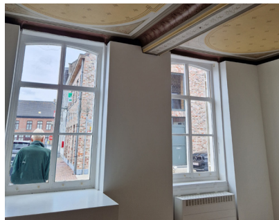
De voorzetwanden interfereren met de plafonddecoratie. Watou, dorpswoning
