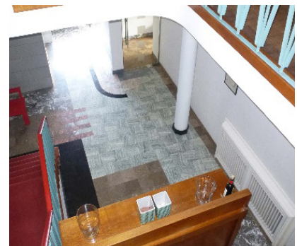
Het is niet wenselijk om de marmeren vloerbekleding in deze inkomhal te isoleren. Het risico op materiaalverlies is te groot, modernistische woning, Roeselare
