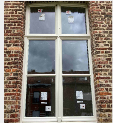
Het schrijnwerk in deze historische hoeve werd naar historisch model vernieuwd en voorzien van restauratieglas. Menen, hoeve Haute Cense
