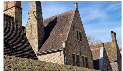
Bakstenen tuitgevel zonder waterdichte afdekking, Brugge Begijnhof
