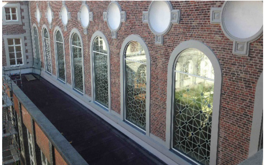
Voor de gietijzeren ramen met originele figuratieve beglazing werden voorzetrampen geplaatst. Kortrijk, OLV ter Engelen
