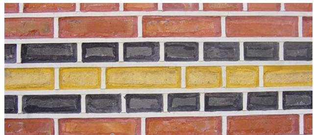
Gesneden voegwerk met ingeleurde bakstenen is een vorstgevoelige gevelafwerking. Binnenisolatie is hier niet evident.
