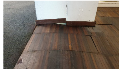
Opstuwing en vervorming ten gevolge van vochtproblemen © NANCY THIELS, ONROEREND ERFGOED
