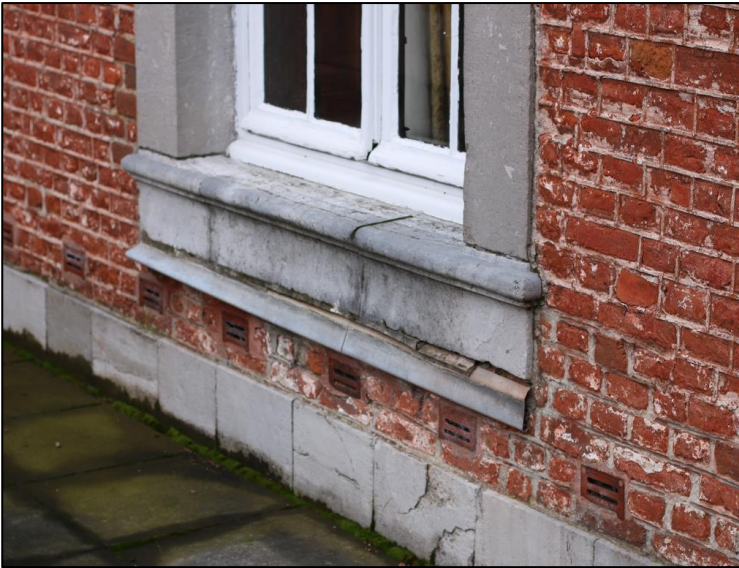
Figuur 92 Verluchtingsgaten van de kruipruimte onder de gelijkvloerse vloer.
