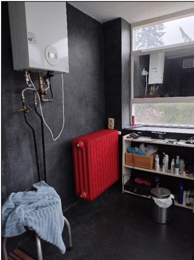
Figuur 50: Detail van de badkamer. Rooster op de luchtafvoerschacht in de badkamer (bovendakse uitmonding) (Foto: Daidalos Peutz bouwfysisch ingenieursbureau).
