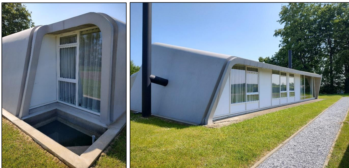
Figuur 164: Tijdens de restauratie van 2018 (tussenscenario) werd omwille van de verhoging van de thermische isolatiekwaliteit het dak licht uitgedikt waardoor het vlak van het dak vijf centimeter hoger ligt dan de bovenkant van de gootrand. In het maximaal scenario energetische renovatie wordt nog een bijkomende dikte van vijf centimeter toegevoegd aan het dakvlak.
