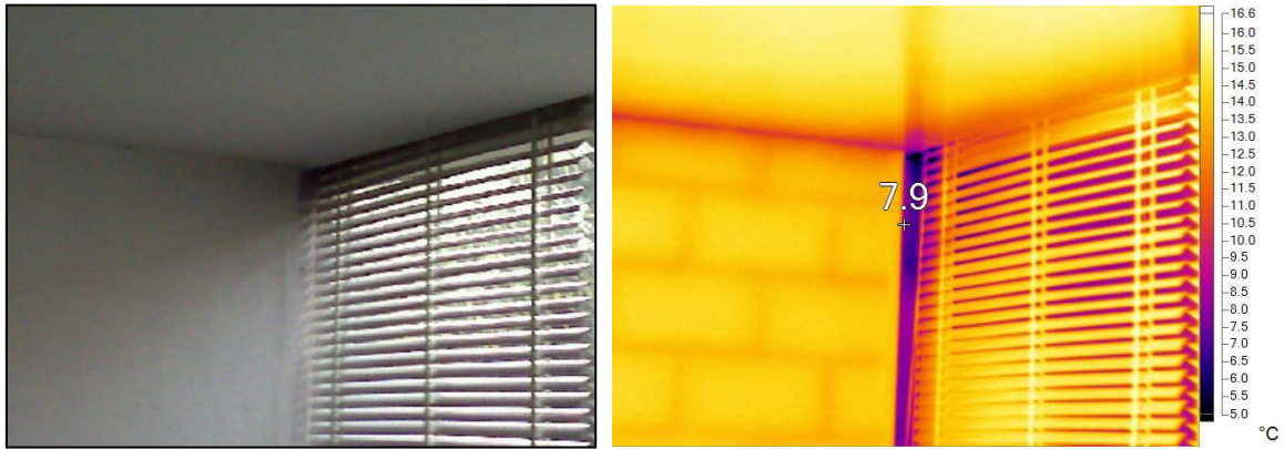
Figuur 53: Aanduiding van cellenbetonblokken van het binnenspouwblad (gemetst met mortel die voor de aftekening van de individuele blokken zorgt), en onaanvaardbaar lage binnentemperatuur op de koudebrug ter hoogte van een buitenhoekkolom (koudebrugfactor 0.5) (Foto: Daidalos Peutz bouwfysisch ingenieursbureau).
