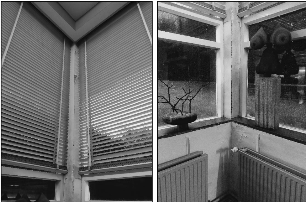
Figuur 52: Kolom in de buitenhoek met onaanvaardbare koudebrugwerking (Foto: Daidalos Peutz bouwfysisch ingenieursbureau).
