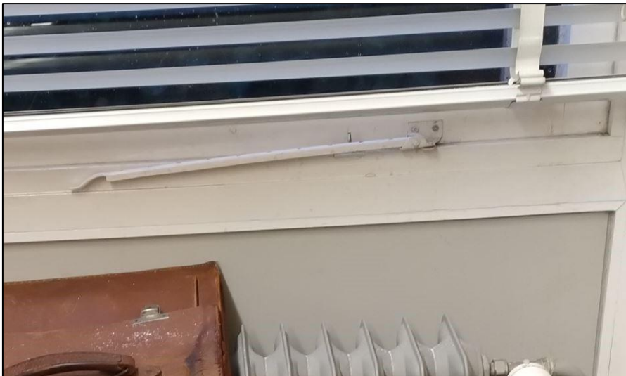
Figuur 66: Detail van de raamvastzetter voor het uitzetraam in het kantoor bij het atelier. (Foto: Daidalos Peutz bouwfysisch ingenieursbureau).
