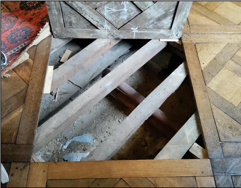
Figuur 89 Het parket is zo gemaakt dat enkele delen uitgenomen kunnen worden om toegang te krijgen tot de ondiepe kruipruimte waarin de leidingen zich bevinden. De leidingen zijn bewust ongeïsoleerd, zodat het systeem in zijn geheel werkt als een soort vloerverwarming. (Foto: Buildwise)
