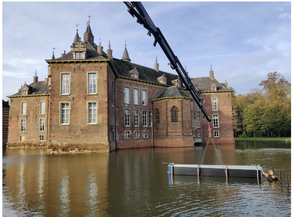
FIGUUR 31: installatie van de warmtewisselaars in de slotgracht van het 14 e eeuwse kasteel de Merode in Westerlo © Extraqt
