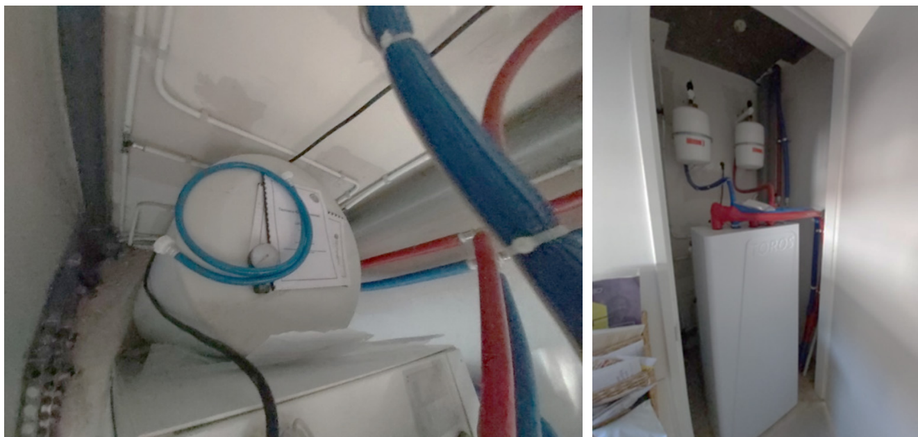
FIGUUR 39: los sanitair warm tapwater voorraadvat (200l), achter een binneneenheid - © VITO
