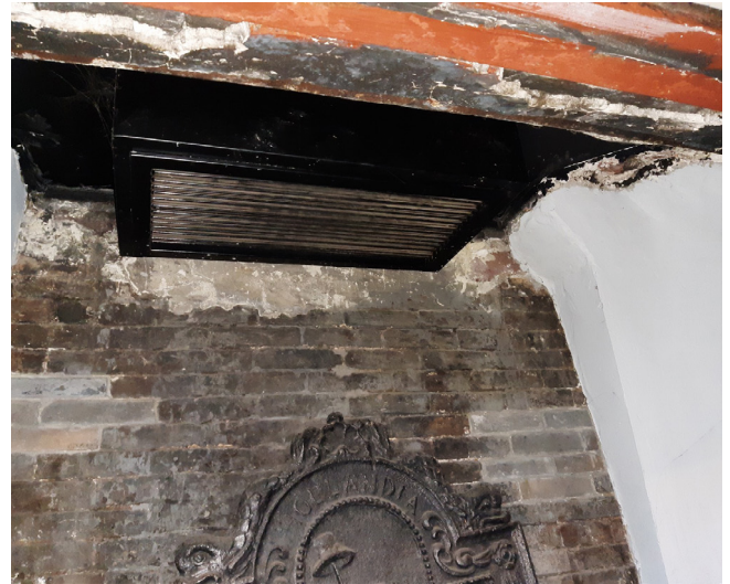
FIGUUR 113: Inbouw van ventilatiekanalen in een schouw (hotel D'Hane Steenhuyse in Gent, Foto: Onroerend Erfgoed)
