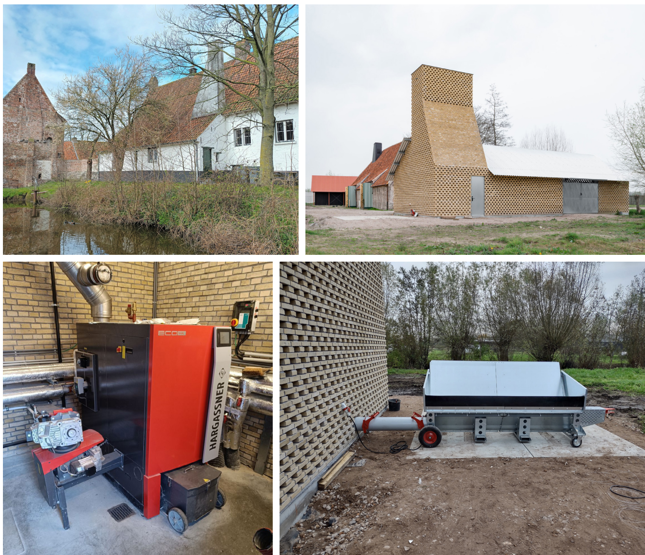
FIGUUR 58: Biomassaketel op de site Huysmanshoeve te Eeklo, boven links: de historische site ©Provincie Oost-Vlaanderen, boven rechts: integratie van de ketel op de site ©Architectura, onder links: de biomassaketel 56 onder rechts aanleverplaats biomassa © Zoom Architecten
