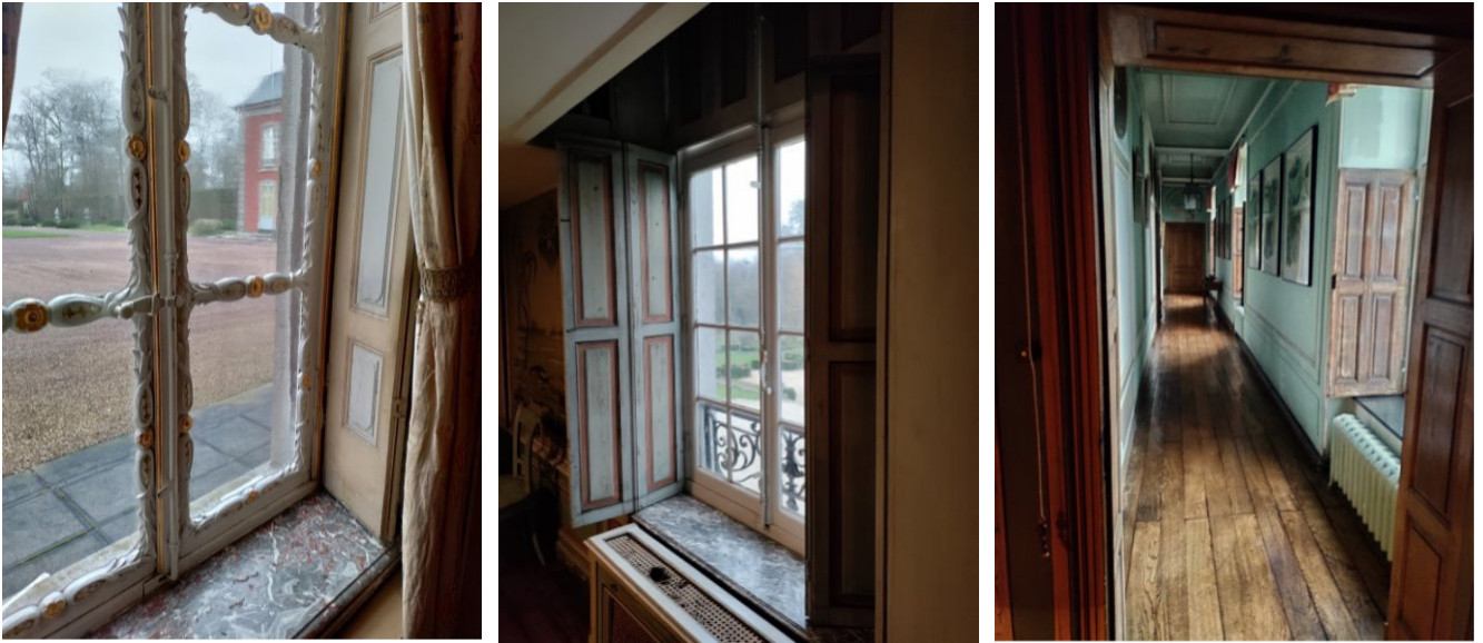
FIGUUR 104. Verschillende types authentieke houten (klap-)luiken aan de binnenzijde van ramen van een kasteel: hetzij over de gehele hoogte, hetzij enkel ter hoogte van de opengaande vleugels, al dan niet gecombineerd met gordijnen. (Bron: Buildwise)
