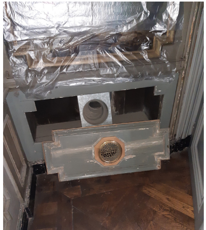
FIGUUR 114: Inbouw van ventilatiekanalen in een schouw (hotel D'Hane Steenhuyse in Gent, Foto: Onroerend Erfgoed)
