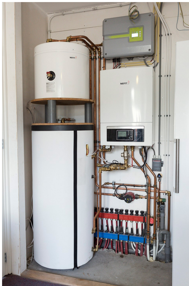
FIGUUR 50: Binnendeel van een zonnecollectorinstallatie met voorraadvat (links onder) en losse bijstook (gasketel, rechts centraal) - © VITO
