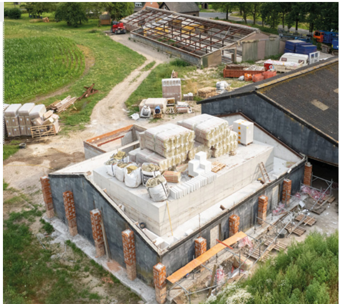
FIGUUR 71: warmte-accu van thermo-chemische warmtepomp in opbouw in oude stal. Dit systeem zal warmte voorzien aan een nieuwbouwproject van 20 appartementen - © Cesar-Energystorage
