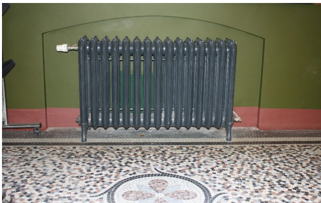
FIGUUR 76. Gerecupereerde ledenradiator in Bijlokecomplex in Gent. De radiator is voorzien van een moderne kraan en aansluiting en geplaatst in een ondiepe nis onder het raam. (foto: Agentschap Onroerend Erfgoed)
