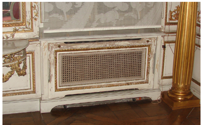
FIGUUR 79. Radiator geplaatst tijdens de jaren 1930 in een daarvoor gecreëerde kast van hout en riet in het kasteel van Hex. De kast is qua kleur en vormgeving geïntegreerd in het interieur dat veel ouder is. Vermoedelijk is de marmeren venstertablet ook aangepast tijdens die fase. (foto: Buildwise)
