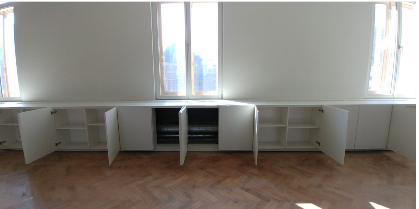
FIGUUR 119: Veeartsenijschool, Anderlecht (foto: urban.brussels) met horizontaal traject van luchtkanalen in vast meubilair (foto: Daidalos Peutz)
