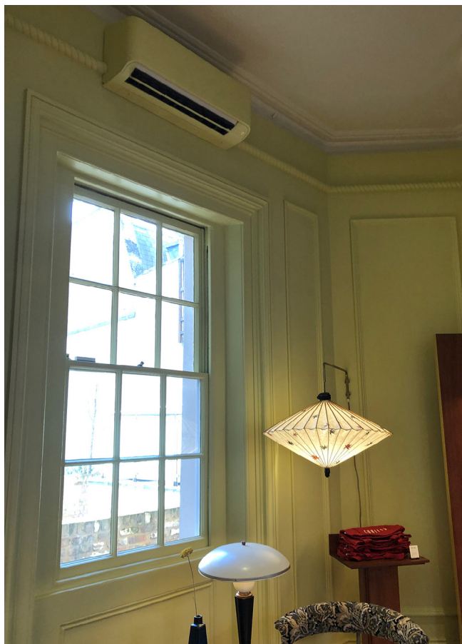
FIGUUR 17: voorbeeld van een in de kleur van het interieur geverfde binneneunit lucht/lucht warmtepomp (Belgravia, Londen, UK) - ©Historic England/Max Fordham LLP
