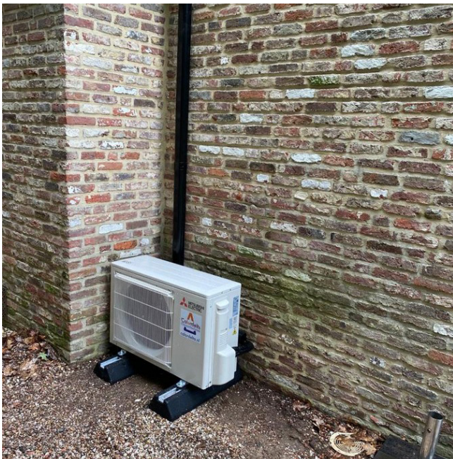
FIGUUR 13: buitenunit van lucht/lucht warmtepomp in split opstelling opgesteld op onopvallende plek - © calordelta
