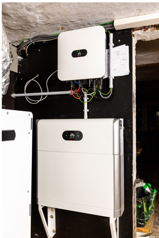
FIGUUR 47: Voorbeeld van een centrale omvormer (bovenaan) en batterij (onderaan), woning in Zurenborg – ©Dieter Daniels, Rooilijn Architectuur
