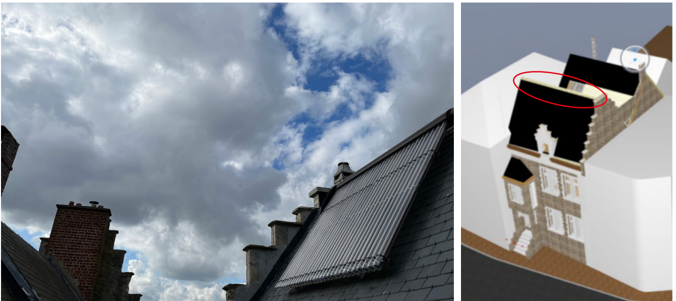
FIGUUR 49: Zonnecollector (linksboven) © Ebt.ca. op een zuidgericht dakdeel van Huis van Boisschot, uit het zicht vanop de straat (erfgoedenergieloket projectfiche 1)
