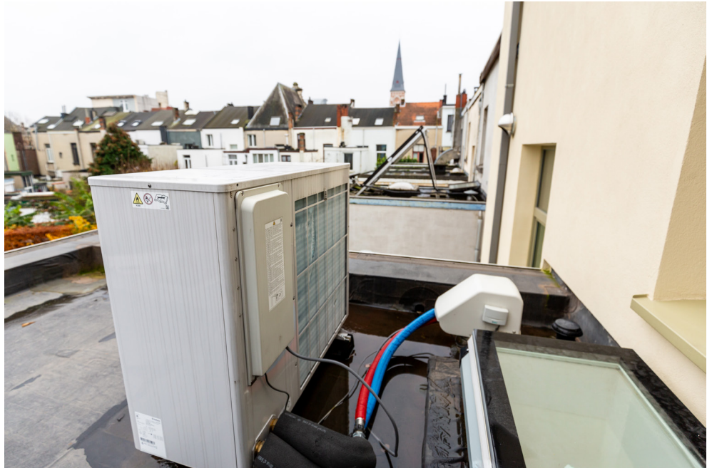
FIGUUR 24: monoblock op achterbouw in Zurenborg, geïsoleerde leidingen en dakdoorvoer – ©Dieter Daniels, Rooilijn Architectuur
