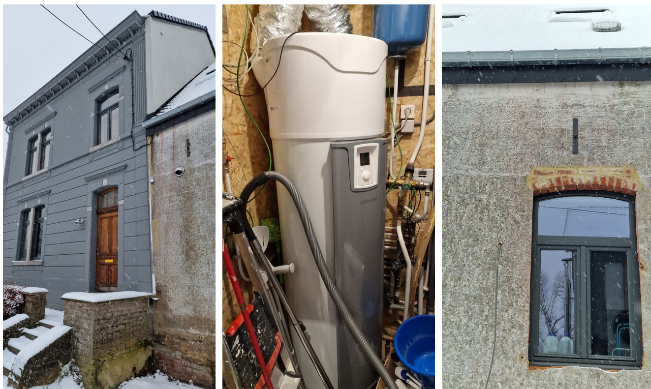
FIGUUR 27: Woning in Waals Gewest met warmtepompboiler. Foto links: luchttoevoer in voorgevel van de aanbouw. Foto midden: warmtepompboiler in technische berging. Foto rechts: luchtafvoer via dakvlak achteraan - ©Buildwise
