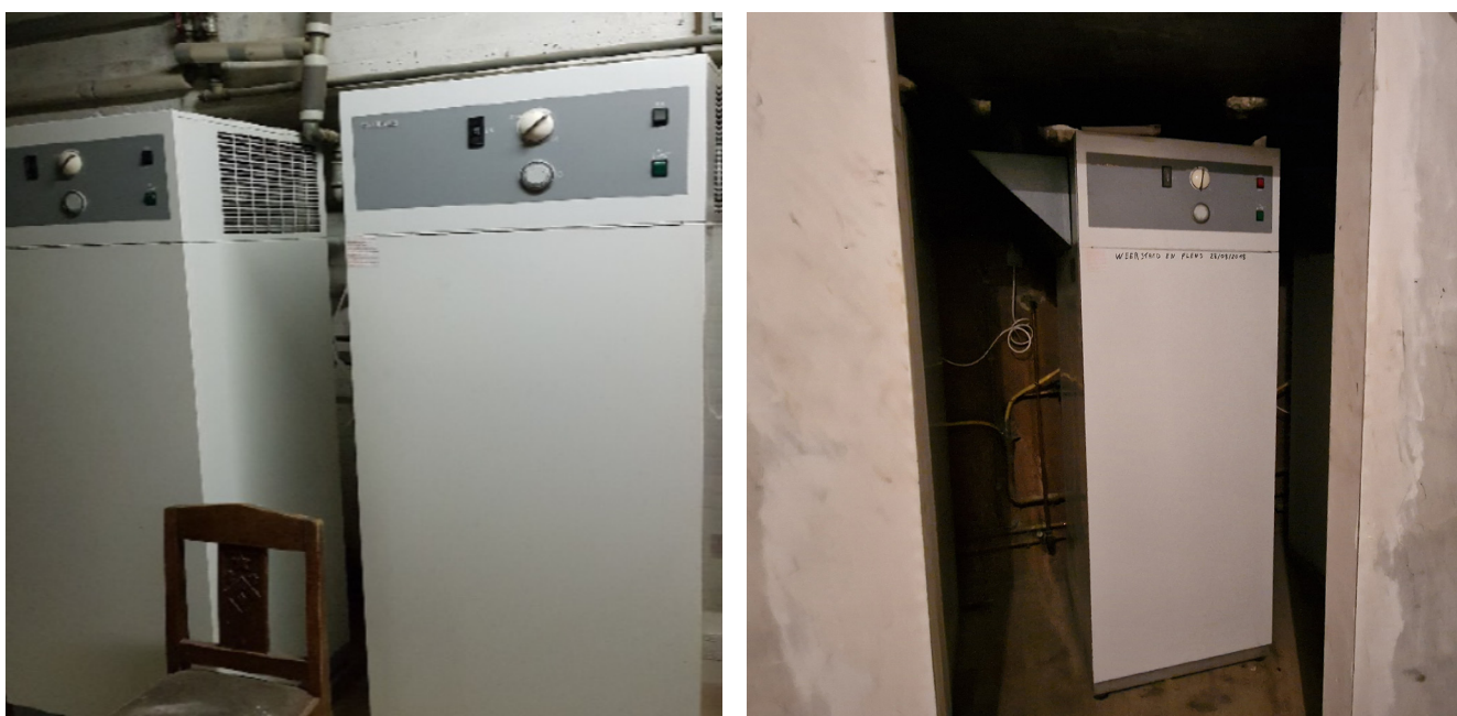
FIGUUR 28 en 29: Warmtepompboiler in de abdij van Tongerlo, foto's Kris De Brabander
