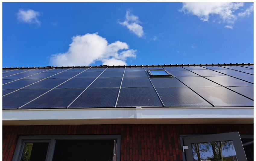
FIGUUR 55: Slecht voorbeeld van panelen geplaatst met beperkte tot geen natuurlijke ventilatie - © vrt0
