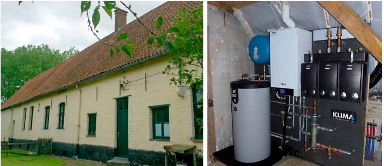
FIGUUR 64: conciërgewoning Ter Vichte, condenserende gasketel – ©Erfgoed en Visie
