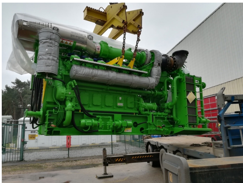
FIGUUR 62: Voorbeeld van een niet-residentiële WKK-installatie (> 50 kW elektrische vermogen) 59
