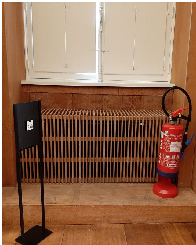
FIGUUR 108. Nieuwe convectoren weggewerkt achter houten roosters van vergelijkbare tint als de omgevende houten elementen. Foto: Agentschap Onroerend Erfgoed.
