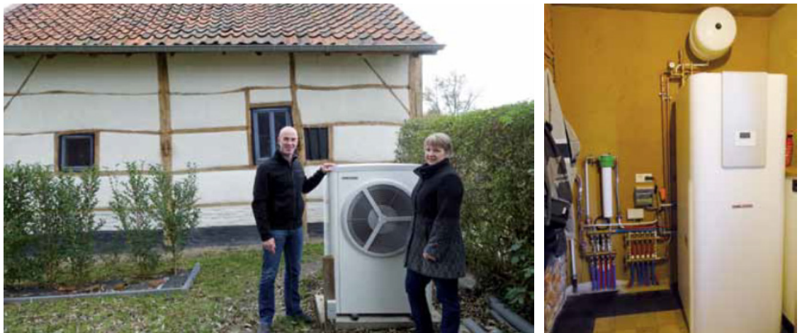
FIGUUR 21: Voorbeeld buiten- en binnenunit warmtepomp in een vakwerkwoning in Zoutleeuw (installatiebouw.be)
