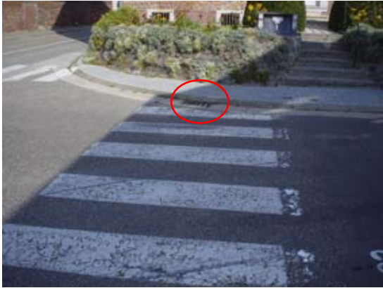
Fig 2.1.4g Op plaatsen waar de logische looproute de rijbaan kruist mogen geen straatkolken voorkomen. Wanneer de openingen het rooster >2cm zijn, bestaat het gevaar dat kleine wielen er in komen vast te zitten. Ook voor dames met hoge hakken kunnen roosters een probleem vormen.
