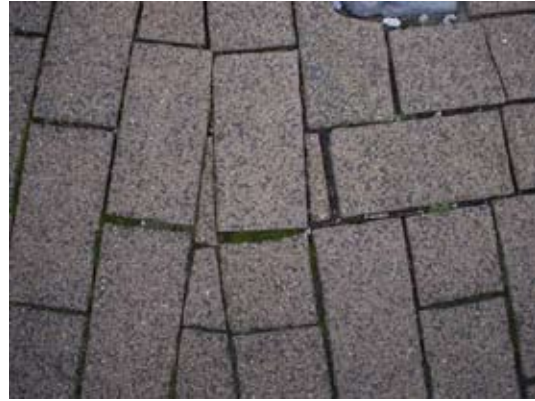
Fig. 3.1c Scherpe punten (<math><45^\circ</math>) en vulstenen kleiner dan een halve steen mogen niet worden gebruikt, omdat het risico op breuk en verzakkingen daarbij groot is.
