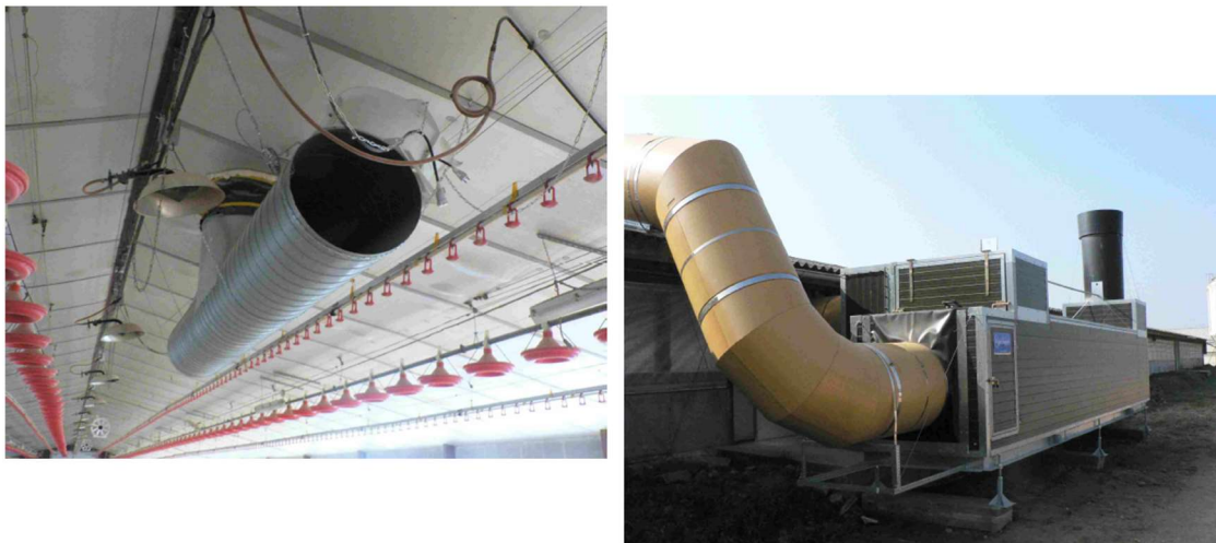
Figuur 6: Voorbeeld van warmtewisselaar voor pluimveehouderij met links de warme lucht die de wisselaar binnenkomt en rechts de warmtewisselaar. 55
