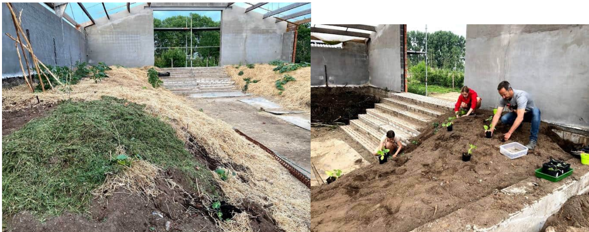
Foto 6 Foto's Houtmeerschen : recup van betonroosters in trap - niveau verschil zichtbaar met maaiveld buiten..
