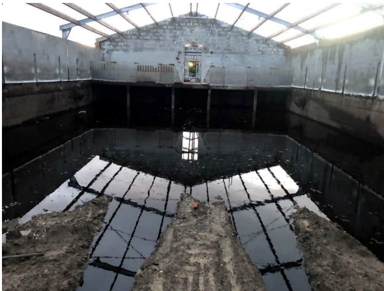
Foto 2 Foto Houtmeerschen: zicht op verwijderde betonroosters (overgang van licht naar donker op de muren geeft 'maaveld' weer waarop de varkens stonden)
