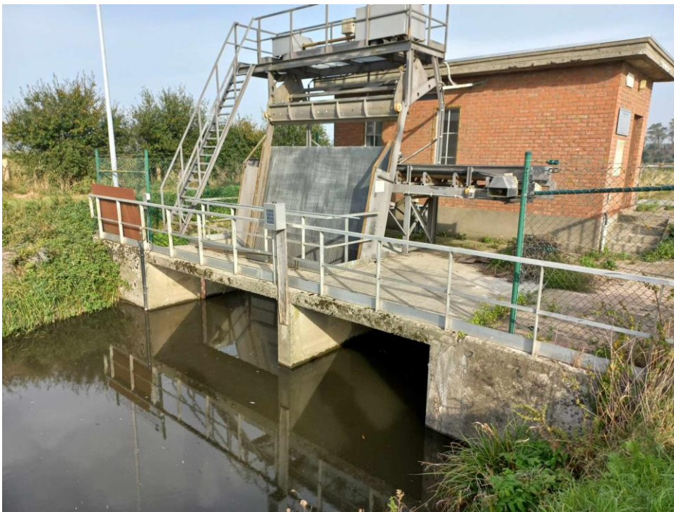
Figuur 3. Het gemaal van Werken bestaat uit twee axiaalpompen en een schuif voor gravitaire afwatering.
