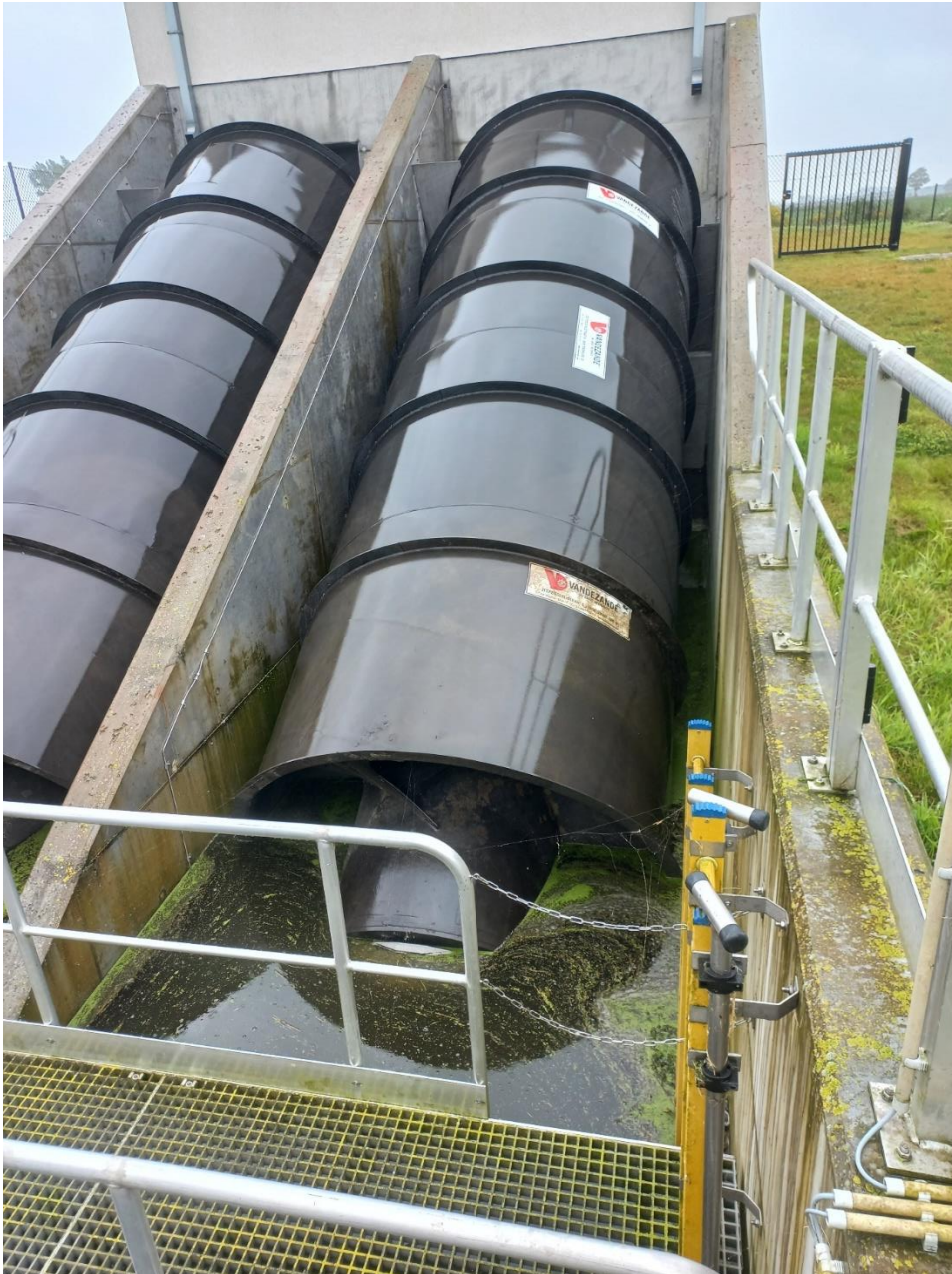
Figuur 9. Twee buisvijzels in de Speievaart, die uitwateren in het kanaal Nieuwpoort-Duinkerke in Veurne. De buisvijzelpompen zijn eigendom van de Westkustpolder en het gemaal werd in 2021 gebouwd.
