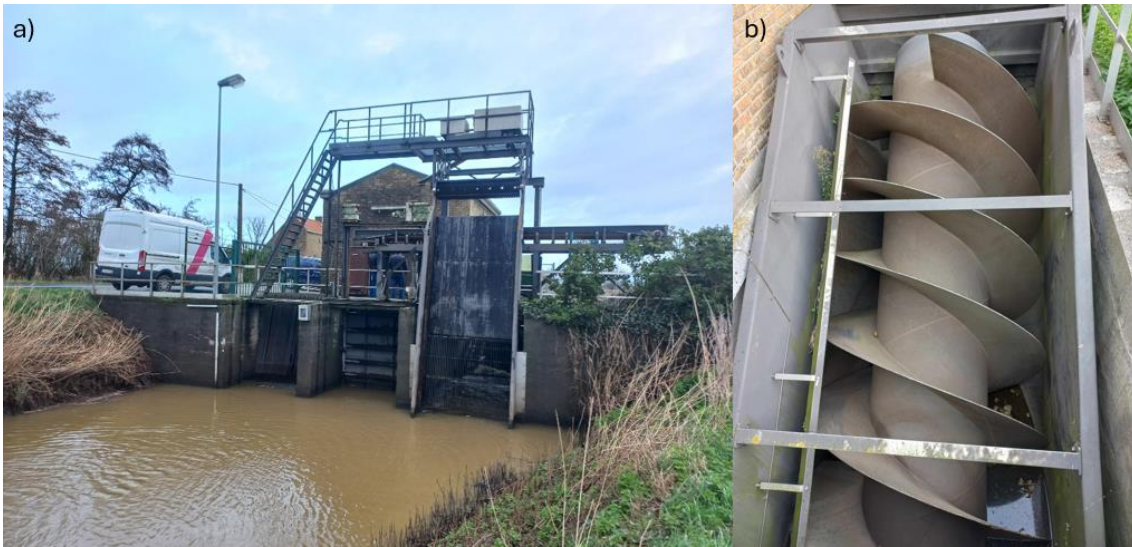
Figuur 2. Het pompemaal van Esen (a) heeft een vijzelpomp (b)(uiterst rechts op foto a) en een traditionele axiaalpom (uiterst links op foto a); deze laatste draait zelden. In het midden zit een schuif voor gravitaire afvoer.
